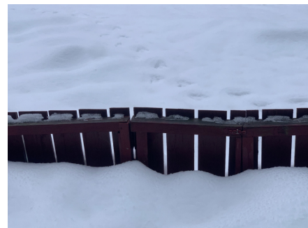
Rekkverk av eldre årgang og har skjevheter
