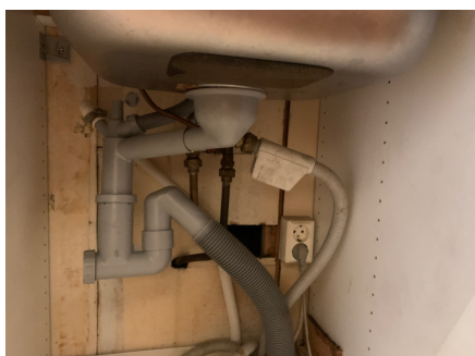
Røropplegget i kjøkken
