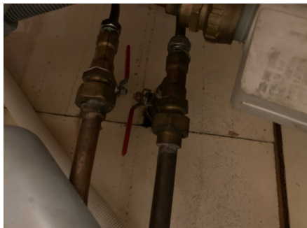
Stoppekraner plassert i kjøkken
