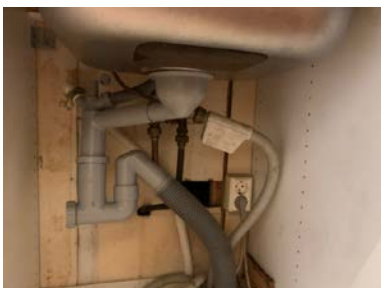
Rørapplegget i kjøkken
