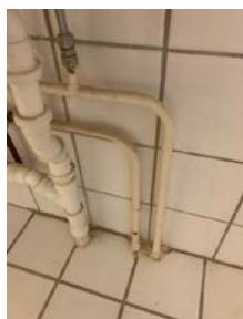
Rørgjennomføringer uten rør membranmansjetter
