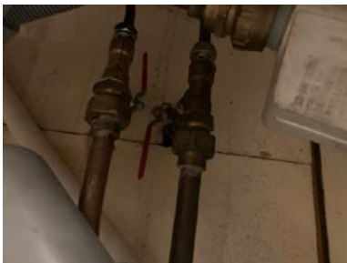
Stoppekraner plassert i kjøkken
