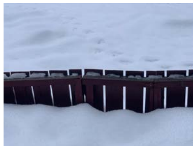
Rekkverk av eldre årgang og har skjevheter
