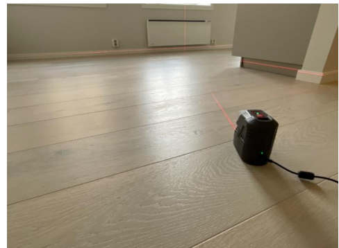
Nivellering stue/kjøkken og entré, avvik ca. 10-20 mm
