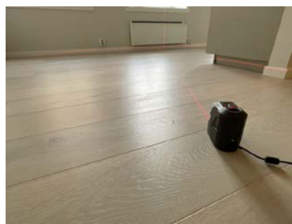
Nivellering stue/kjøkken og entré, avvik ca. 10-20 mm
