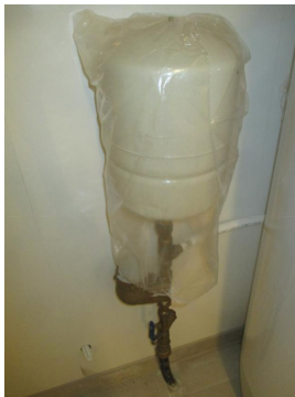
Innvendig stoppekran og trykktank.
