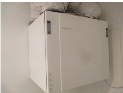
Selve enheten er plassert på teknisk rom.
