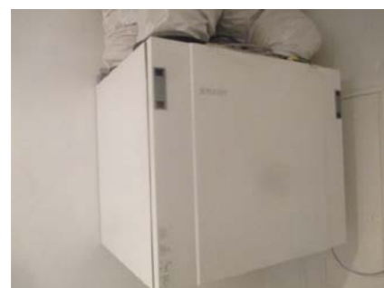
Selve enheten er plassert på teknisk rom.
