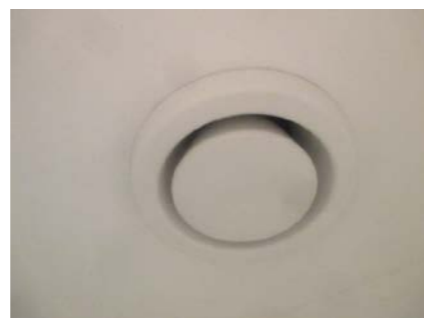
Avtrekk i himling.
