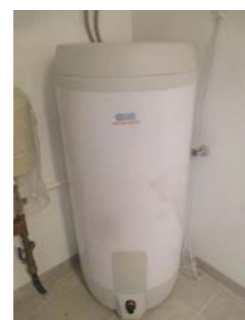
Bereider er plassert på teknisk rom.
