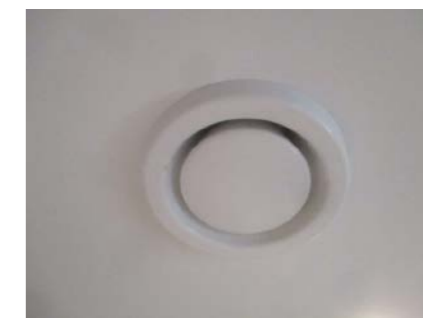
Avtrekk i himling.
