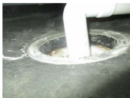
Sluk under dusjkabinett.
