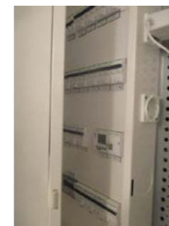
Sikringsskapet er plassert på teknisk rom og kan ikke åpnes helt på grunn av enheten for ventilasjon.
