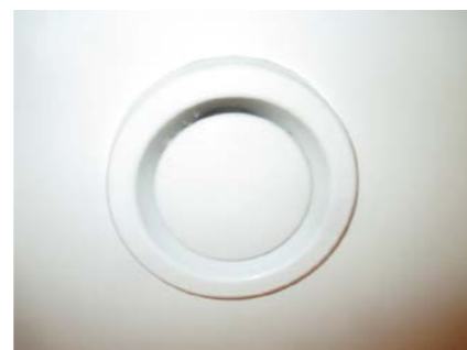
Avtrekk i himling.
