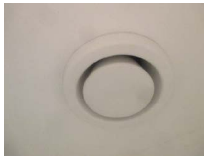
Avtrekk i himling.
