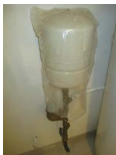
Innvendig stoppekran og trykktank.
