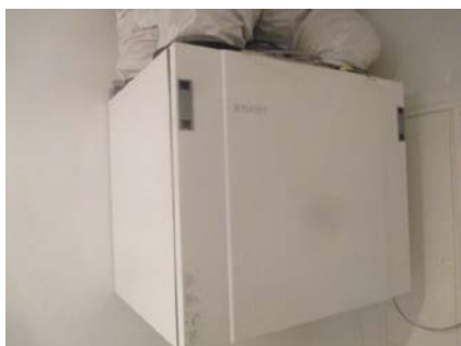
Selve enheten er plassert på teknisk rom.
