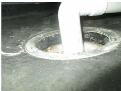
Sluk under dusjkabinett.
