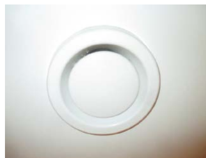
Avtrekk i himling.
