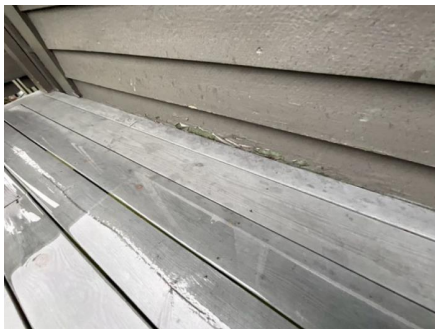
Bilde av avflasset fasade under stuevinduer.
