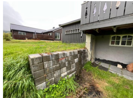
Mangletne bortledning av vann fra takrenne.
