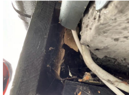
Bilde av luftesjikt i ytterhjørne
