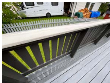
Bilde av slitt overflate på rekkverk
