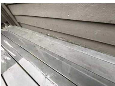
Bilde av avflasset fasade under stuevinduer.
