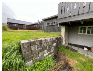
Mangletne bortledning av vann fra takrennen.
