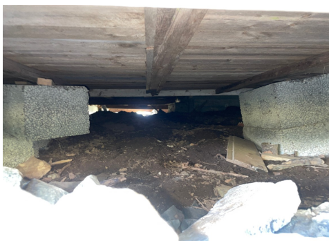
Provisoriske og skeive fundamenter
