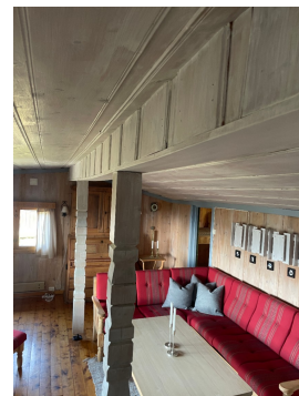
Synlige nedbøyninger i takkonstruksjon og bærekonstruksjon innvendig.
