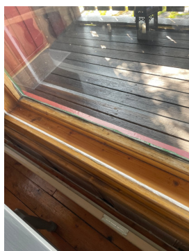
Tegn på innvendig kondensering.
