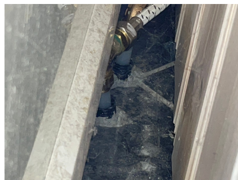
Ufaglig tettesjikt rundt rørgjennomføring i gulv.
