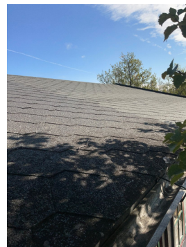
Pappshingel med synlig værslitasje/mose.
