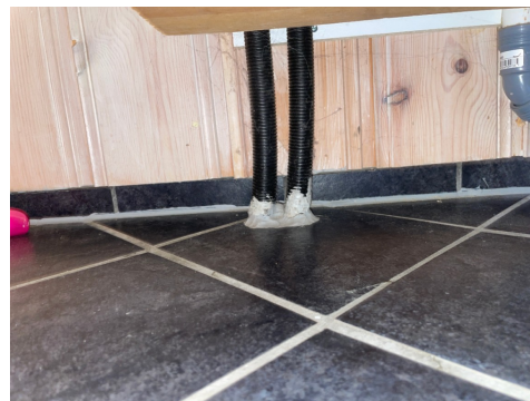
Ufaglig tettesjikt rundt rørgjennomføring i gulv.
