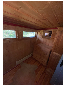
Synlige nedbøyninger i takkonstruksjon
