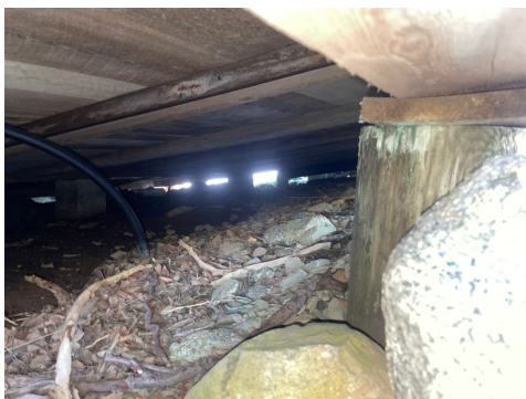
Provisoriske og skeive fundamenter
