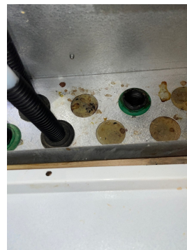
Ekskrementer fra mus i fordelerskap
