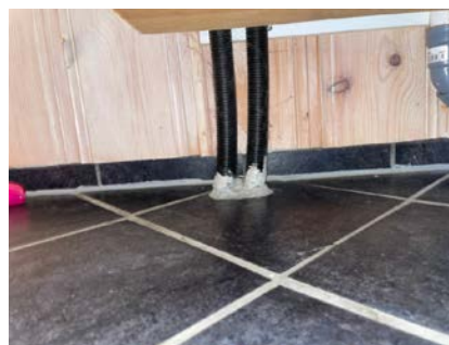
Ufaglig tettesjikt rundt rørgjennomføring i gulv.
