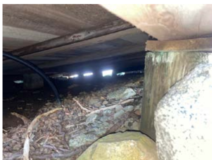
Provisoriske og skeive fundamenter
