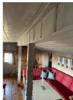
Synlige nedbøyinger i takkonstruksjon og bærekonstruksjon innvendig.
