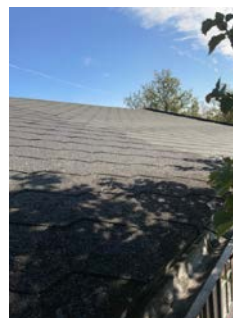
Pappshingel med synlig værslitasje/mose.
