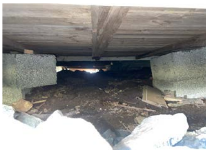
Provisoriske og skeive fundamenter
