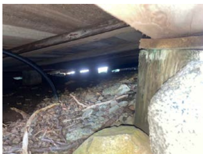
Provisoriske og skeive fundamenter
