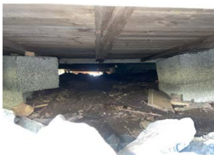
Provisoriske og skeive fundamenter
