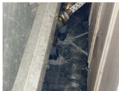
Ufaglig tettesjikt rundt rørgjennomføring i gulv.
