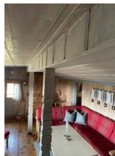
Synlige nedbøyinger i takkonstruksjon og bærekonstruksjon innvendig.
