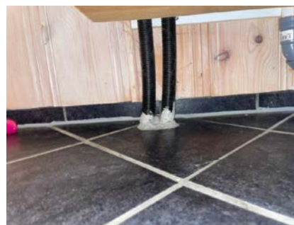
Ufaglig tettesjikt rundt rørgjennomføring i gulv.
