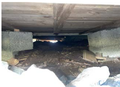
Provisoriske og skeive fundamenter
