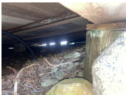
Provisoriske og skeive fundamenter
