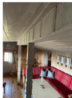
Synlige nedbøyinger i takkonstruksjon og bærekonstruksjon innvendig.
