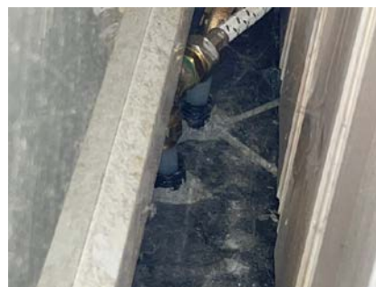
Ufaglig tettesjikt rundt rørgjennomføring i gulv.
