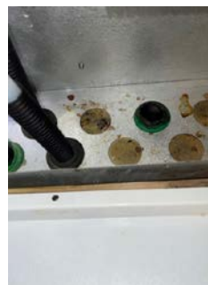
Ekskrementer fra mus i fordelerskap
