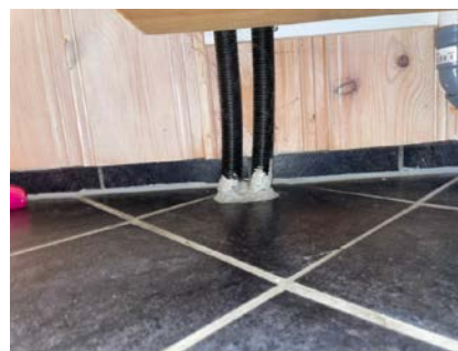
Ufaglig tettesjikt rundt rørgjennomføring i gulv.
