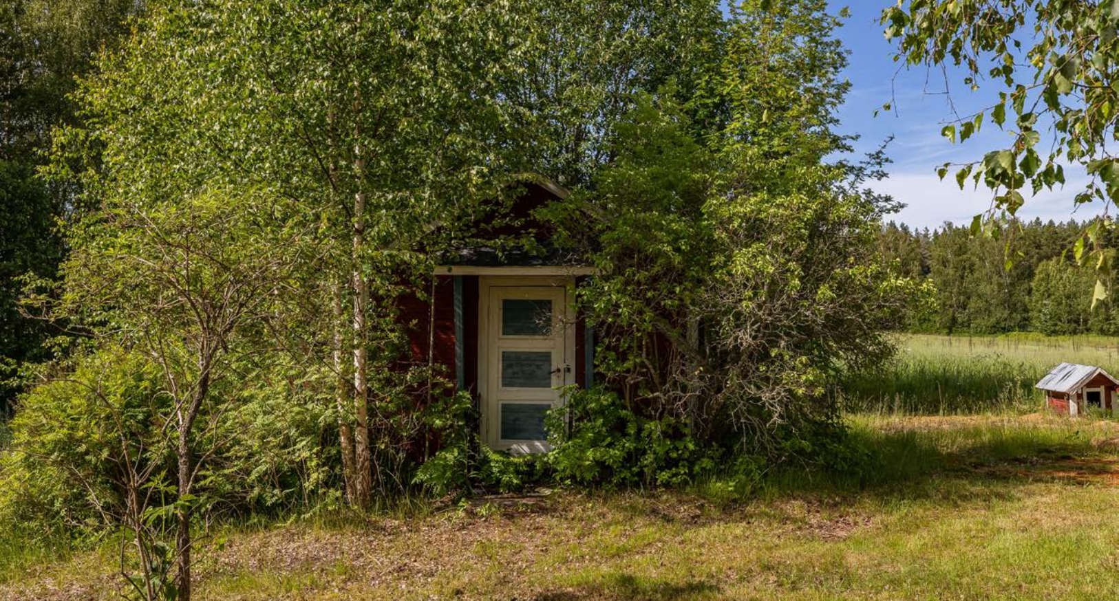
Bygningsmassen bærer preg av å være i dårlig forfatning.
