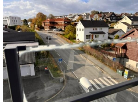
Fuktskade i glass rekkverk.
