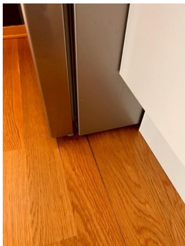
Kondens skade i parkett under kjøleskap.
