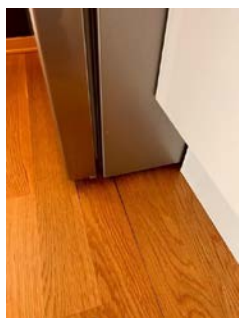
Kondens skade i parkett under kjøleskap.
