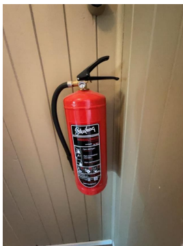
Brannslukker i gang 1. etasje som er sist kontrollert 2009
