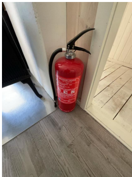
Brannslukker fra 2008 på soverom 4
