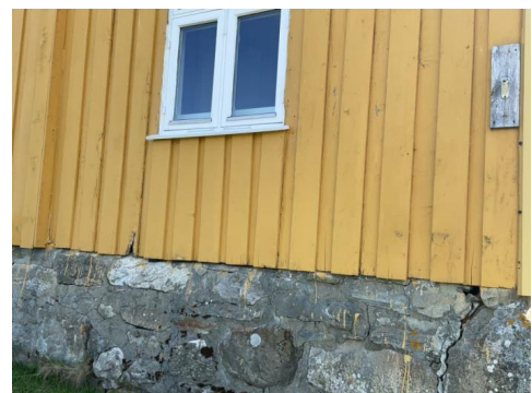
Synlig råte i deler av ledning på forsiden av boligen
