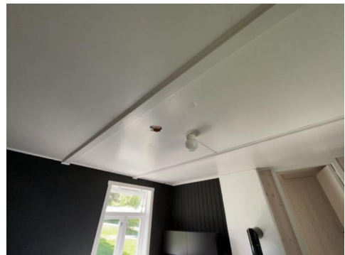
Skade i himling på soverom 4
