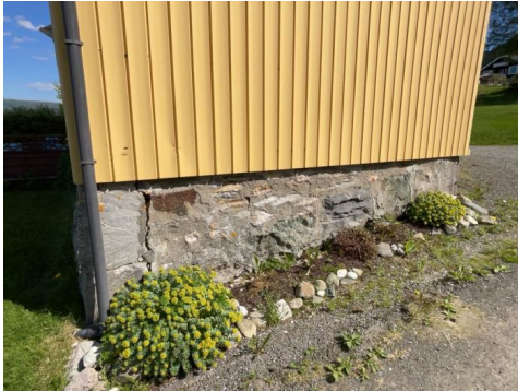
Sprekk i mur på nedre hjørne krypkjeller
