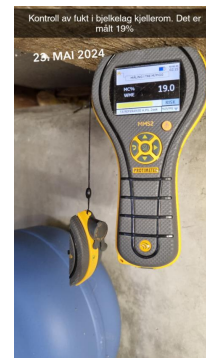
Kontroll av fukt i kjellerrom. Det er målt 19 %
