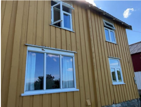
Vinduer i 2. etasje mangler vannbrett over vinduet
