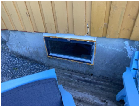
Vinduer i kjeller er montert uten karm og har ikke mulighet for å åpnes.
