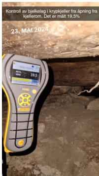
Kontroll av bjelkelag i krypkjeller fra åpning ved kjellerrom. Det er målt 19,5%
