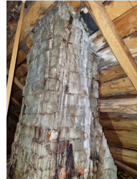
Synlig fuktmerker/skader ved pipe. Ingen fukt på befaringsdagen
