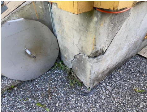
Sprekk i mur ved trapp til kjeller
