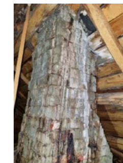
Synlig fuktmerker/skader ved pipe. Ingen fukt på befaringsdagen
