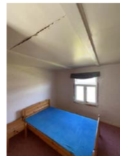
Skade i himling på soverom 1. Mangler utforinger og lister på vindu.
