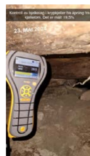
Kontroll av bjelkelag i krypkjeller fra åpning ved kjellerrom. Det er målt 19,5%
