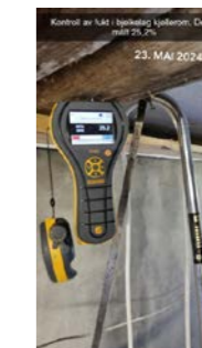
Kontroll av fukt i kjellerrom. Det er målt 25,2 %
