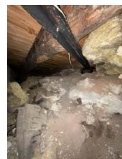
Krypkjeller er ikke mulig å kontrollere grunnet lav høyde
