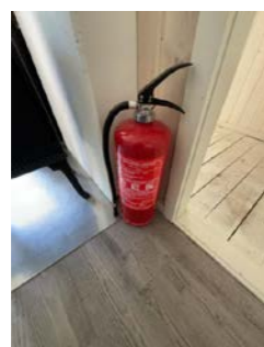
Brannslukker fra 2008 på soverom 4
