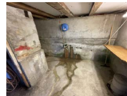
Synlig fukt gjennomtrengning i bakmur
