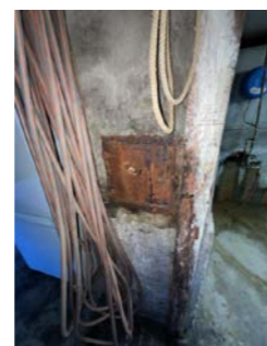
Hengsler på sotluke er knekt. Sotluke er låst fast med lås og det er ingen brannfare slik den står på befaringsdagen. Luke må utbedres/skiftes
