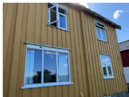
Vinduer i 2. etasje mangler vannbrett over vinduet
