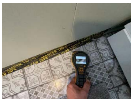
Fuktavvik på gulv ved dusjkabinett mot yttervegg uten forhøyde fuktavvik
