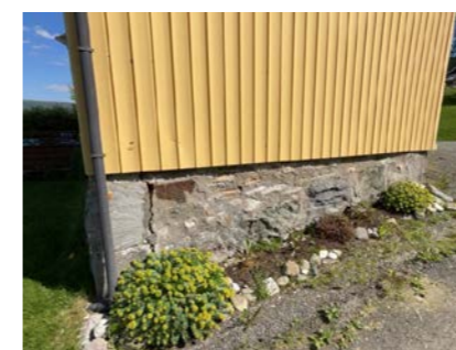
Sprekk i mur på nedre hjørne krypkjeller
