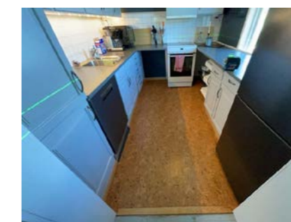
1. etasje Plassering av laser ved kontroll av kjøkken. Det er målt 30 mm høydeforskjell gjennom rommet . TG 2. Over en avstand på 1,5 meter er det målt 30 mm fra døråpning til gulv foran vask. TG 3. Knirk i gulvet ved belastning.
