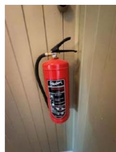
Brannslukker i gang 1. etasje som er sist kontrollert 2009
