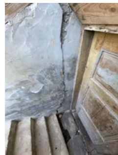
Sprekk i støttemur på trapp ved overgang trapp og bolig
