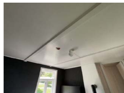
Skade i himling på soverom 4
