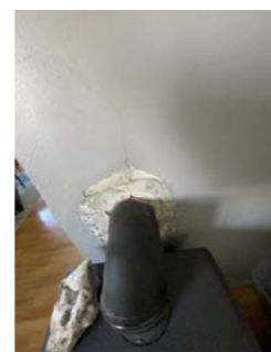
Sprekk i pipe over røykrør i 1. etasje
