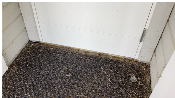
Det mangler tetting/beslag under dører.
