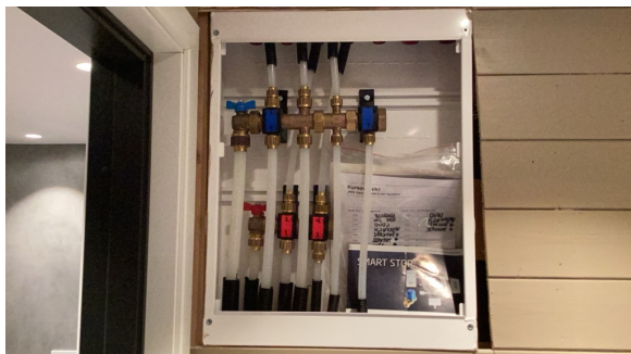
Kontroll av fordelerskap.
