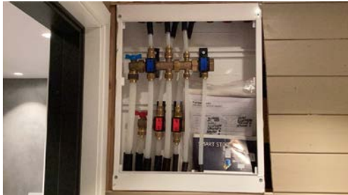
Kontroll av fordelerskap.
