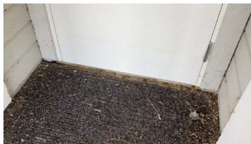
Det mangler tetting/beslag under dører.
