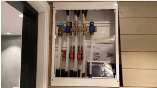
Kontroll av fordelerskap.
