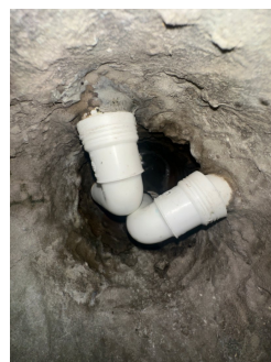
Eldre sluk med ukjent tettesjikt.
