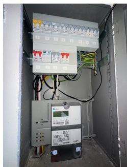
Sikringsskap med automatsikringer.
