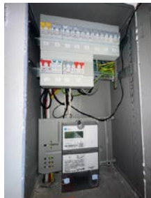
Sikringsskap med automatsikringer.
