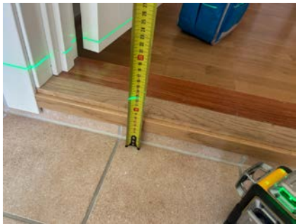
Oppkant ved dør.
