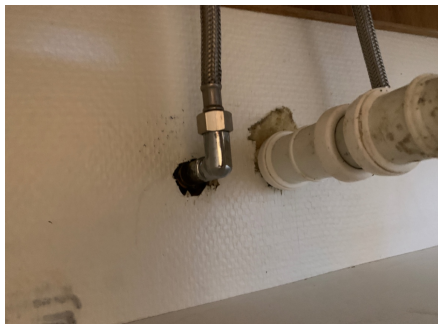
Utette rørgjennomføringer i våtsonen
