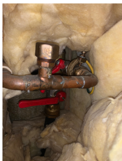
Hovedstoppekran i luke i bad. Fungerer som tiltenkt
