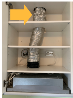
Skade på rør, hindrer fri flyt av luft
