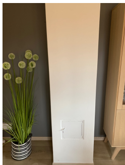
Pipe. Mangler brennbart materiale under sotluke
