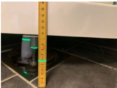
Okei fall fra topp flis ved dør till topp flis ved sluk, men under dagens krav
