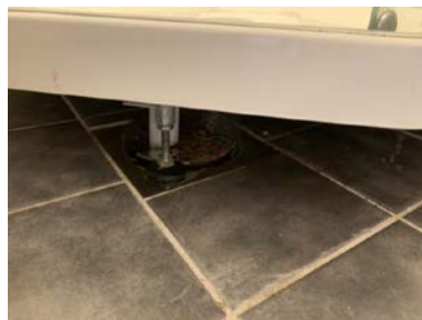
Fot for dusjkabinett vanskeligjør slukets tilgjengelig noe
