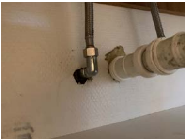
Utette rørgjennomføringer i våtsonen
