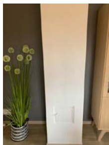
Pipe. Mangler brennbar materiale under sotluke
