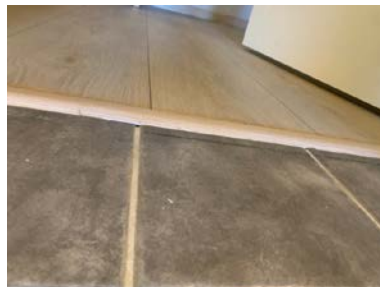
Mangler stoppkant ved en evt lekkasje
