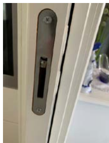
Skyvedøren mangler grep og har treg skyvefunksjon
