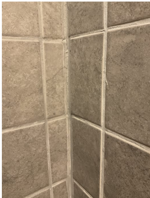
Sprekker i fugemasse/silikon.
