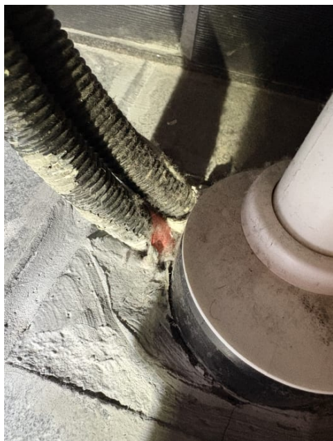
Manglende tetting av gjennomføring i gulv.
