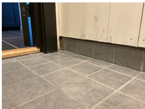
Ufulstendig membran ved dør og manglende sokkelflis.
