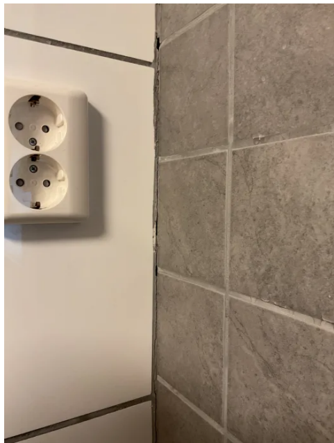
Sprekker i fugemasse/silikon.
