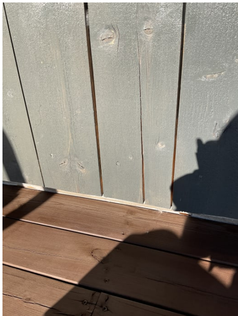
Sprekker i kledning.
