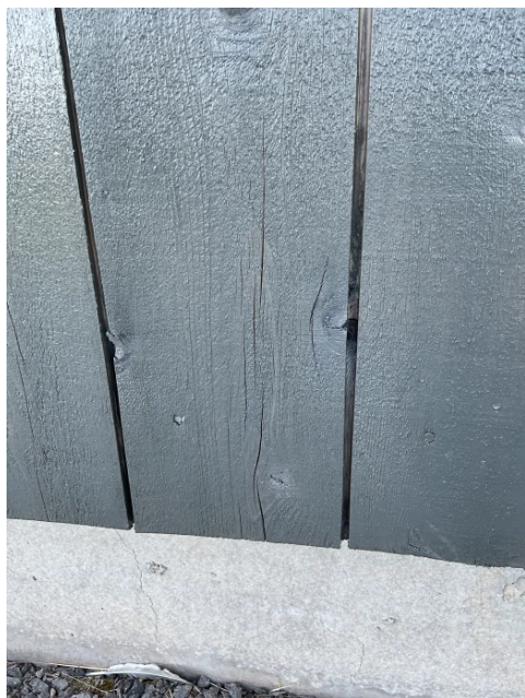
Sprekker i kledning.
