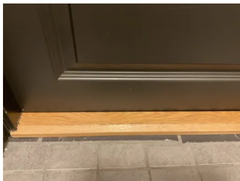
Manglende tilluft vaskerom.
