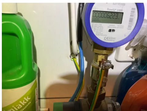
Utette gjennomføringer i vegg.
