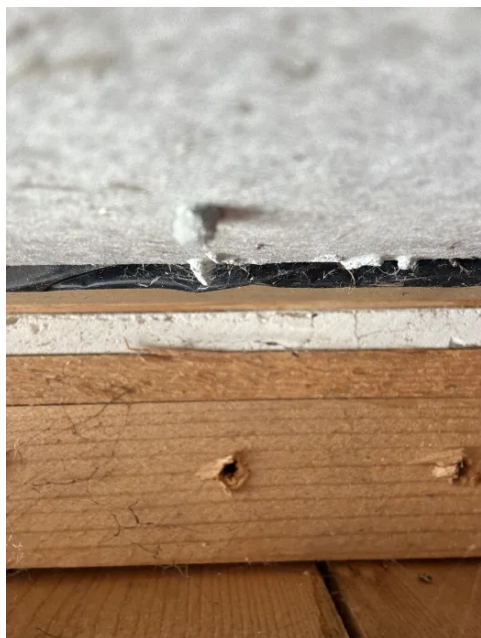
Manglende lufting av kledning.
