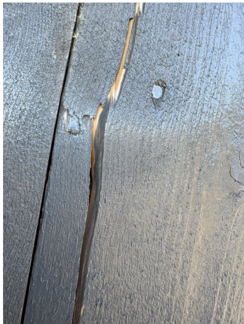
Sprekker i kledning.
