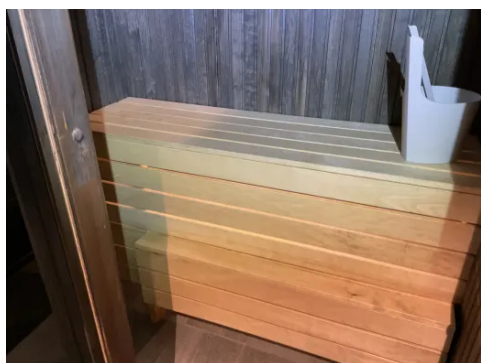
Ufulstendig membran ved dør og manglende sokkelflis.
