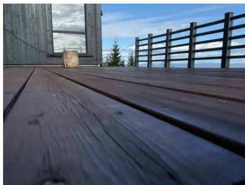
Skjevheter i gulvet.
