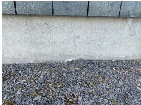
Sprekker i grunnmur.
