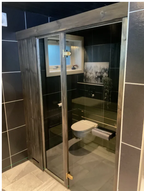
Ufulstendig membran ved dør og manglende sokkelflis.
