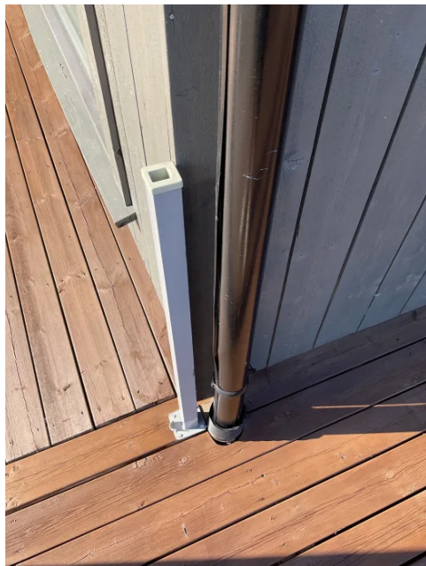
Frostsprenng i nedløp.
