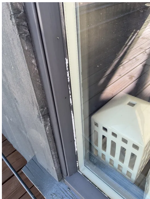
Avflassing av maling.
