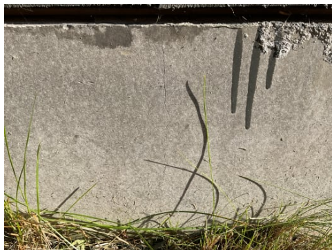
Sprekker i grunnmur.
