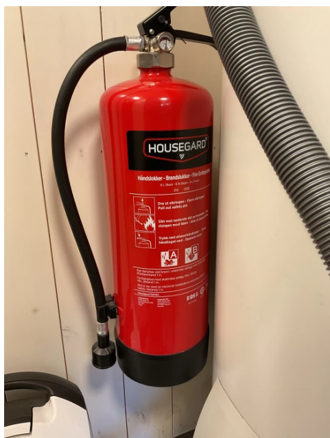
Brannslukker plassert på vaskerom.
