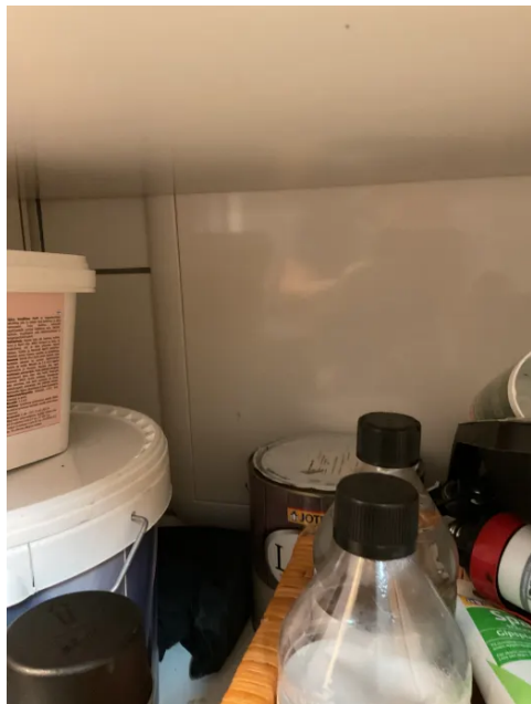
Fordelerskap til vann.
