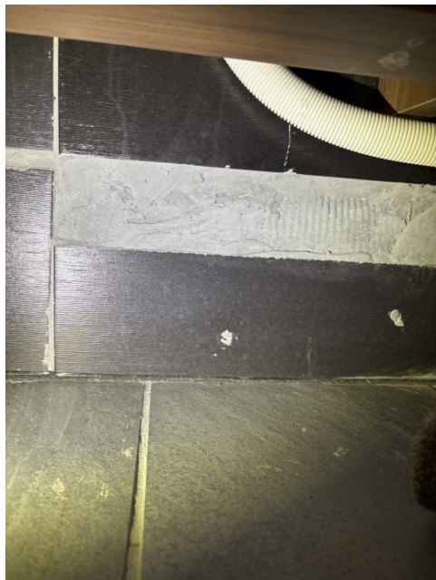
Manglende flis under innredning.
