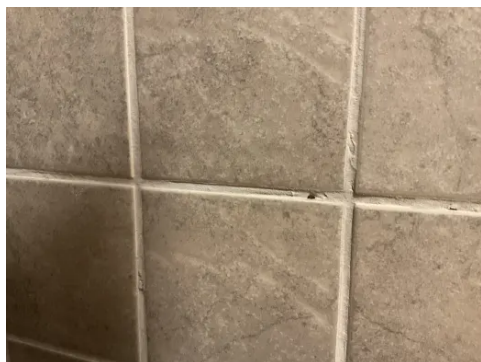
Sprekker i fugemasse/silikon.
