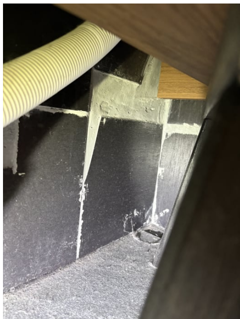
Manglende flis under innredning.
