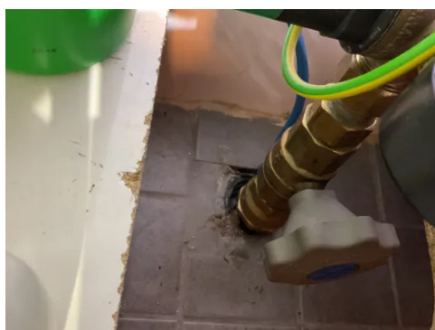
Utette gjennomføringer i gulv.
