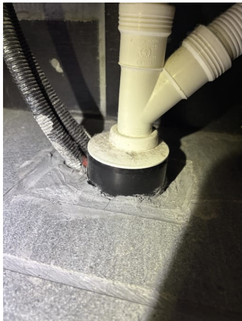
Manglende tetting av gjennomføring i gulv.
