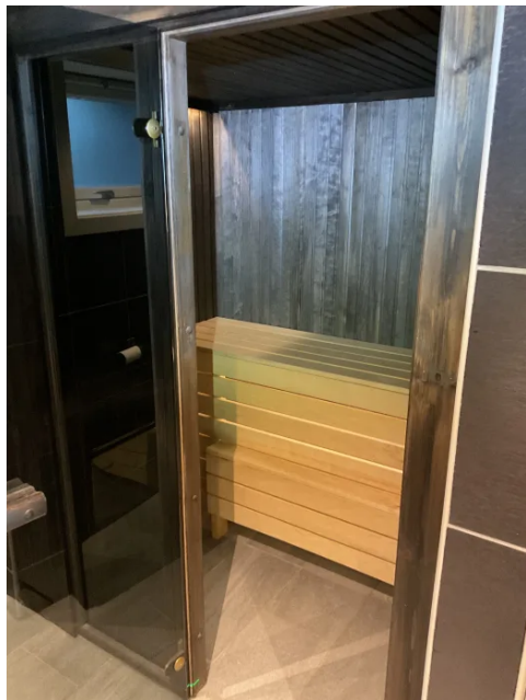
Ufulstendig membran ved dør og manglende sokkelflis.
