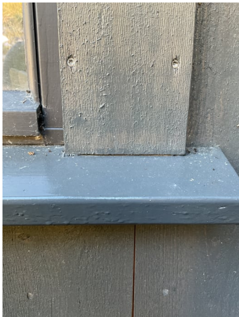
Kort avstand mellom panel og vannbrett.
