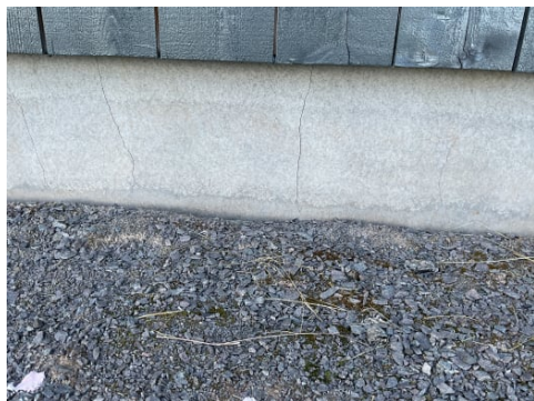
Sprekker i grunnmur.
