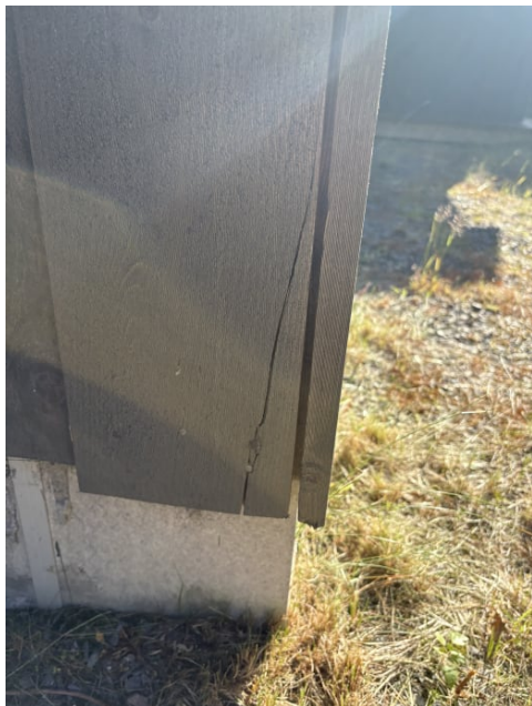
Sprekker i kledning.
