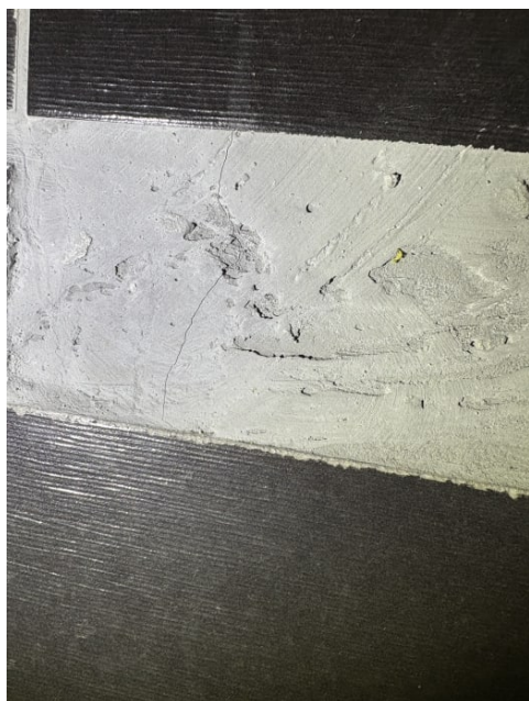
Manglende flis under innredning.
