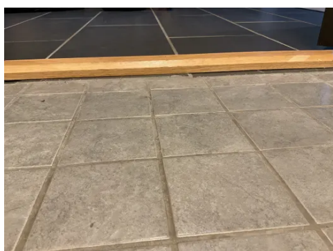
Manglende tettesjikt ved dør.
