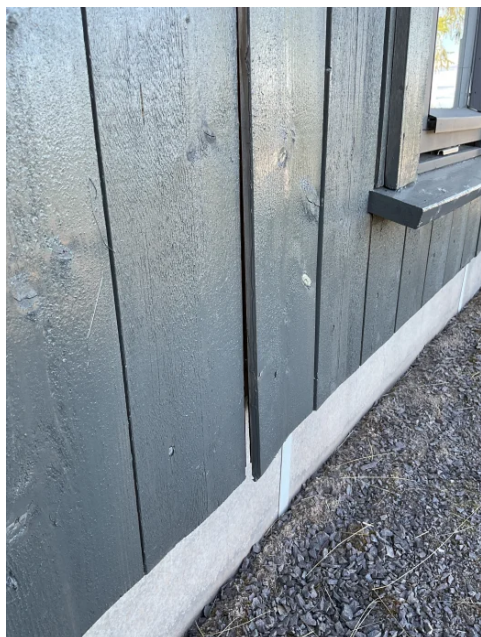
Sprekker i kledning.
