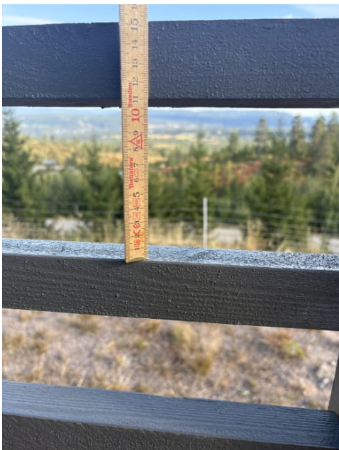
Åpning i rekkverket.
