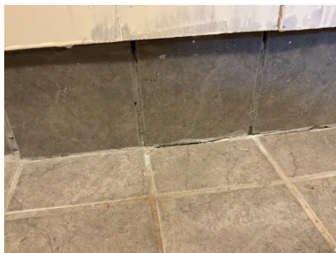
Sprekker i fugemasse/silikon.
