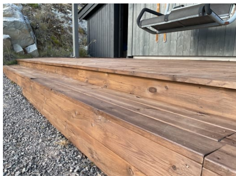
Skjevheter i gulvet.
