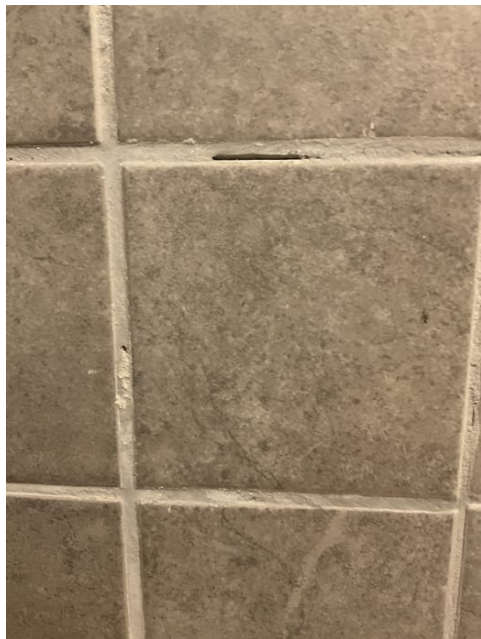
Sprekker i fugemasse/silikon.
