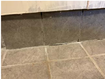
Sprekker i fugemasse/silikon.
