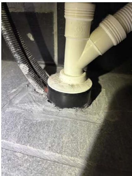
Manglende tetting av gjennomføring i gulv.
