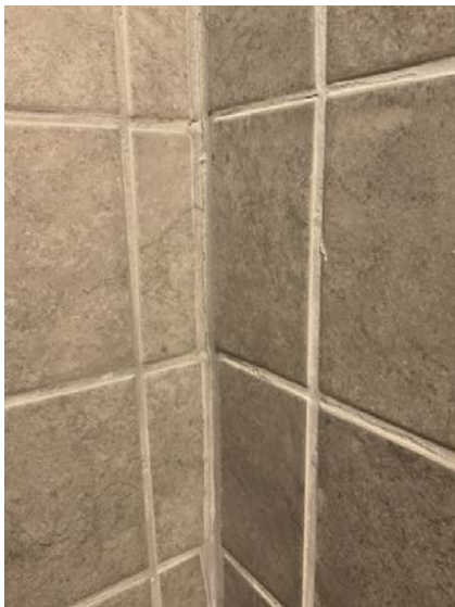
Sprekker i fugemasse/silikon.
