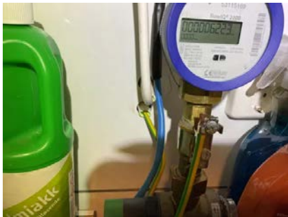
Utette gjennomføringer i vegg.
