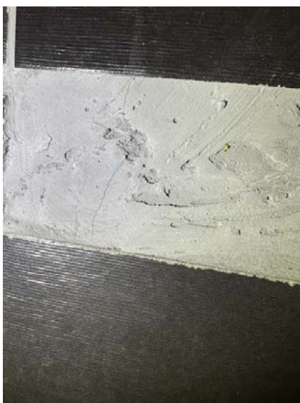
Manglende flis under innredning.
