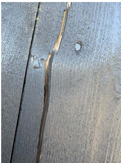
Sprekker i kledning.
