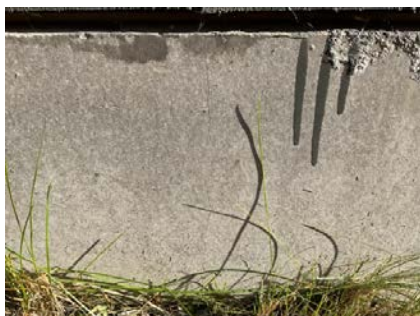
Sprekker i grunnmur.
