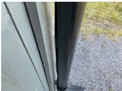
Frostspreng i nedløp.
