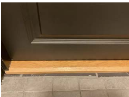
Manglende tilluft vaskerom.
