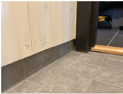
Ufulstendig membran ved dør og manglende sokkelflis.
