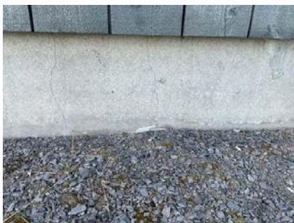
Sprekker i grunnmur.
