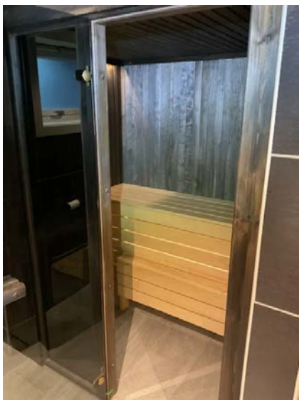
Ufulstendig membran ved dør og manglende sokkelflis.
