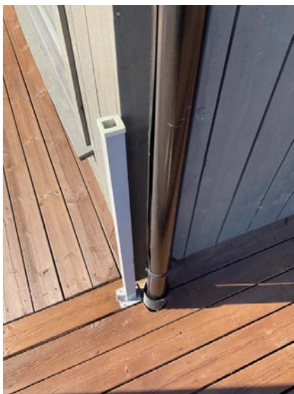
Frostsprengh i nedløp.
