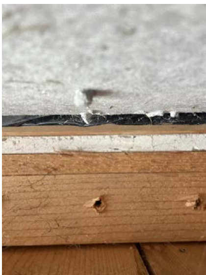
Manglende lufting av kledning.
