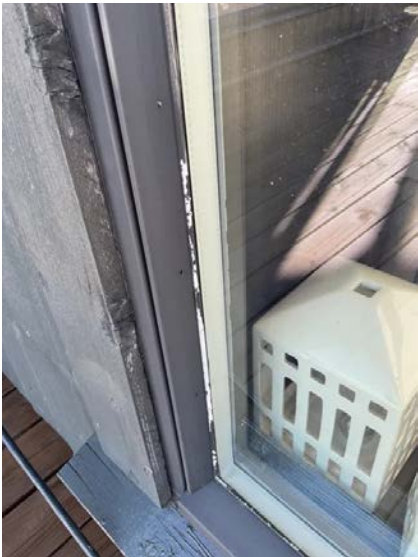
Avflassing av maling.
