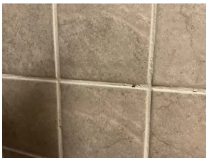
Sprekker i fugemasse/silikon.
