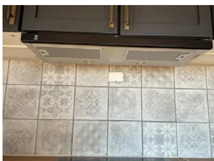
Ventilator og komfyrvakt.
