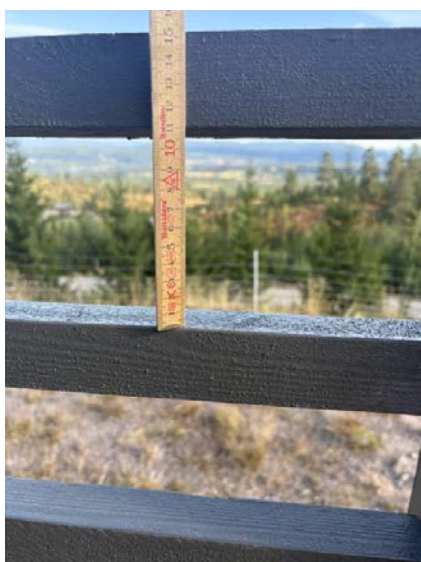
Åpning i rekkverket.
