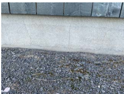
Sprekker i grunnmur.
