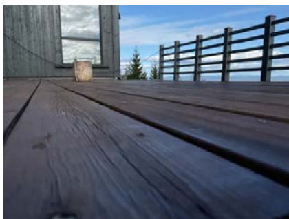
Skjevheter i gulvet.
