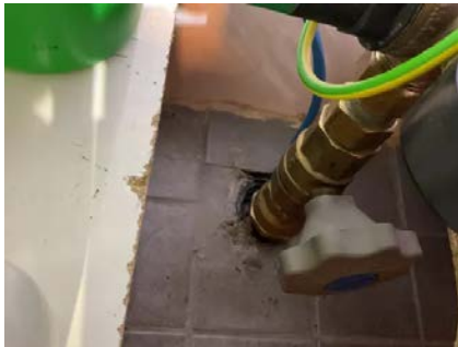
Utette gjennomføringer i gulv.
