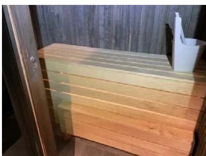
Ufulstendig membran ved dør og manglende sokkelflis.
