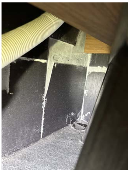
Manglende flis under innredning.
