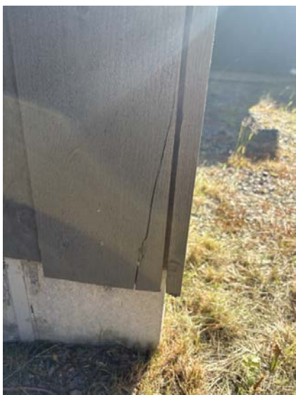
Sprekker i kledning.
