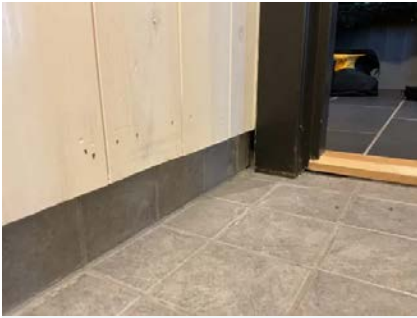
Ufulstendig membran ved dør og manglende sokkelflis.
