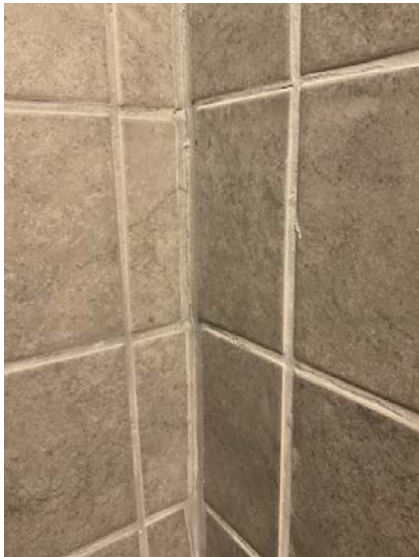
Sprekker i fugemasse/silikon.
