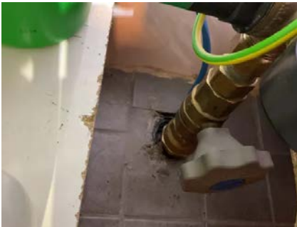
Utette gjennomføringer i gulv.
