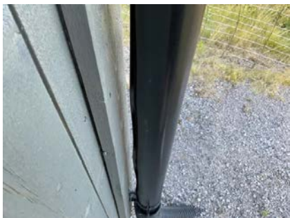
Frostspreng i nedløp.
