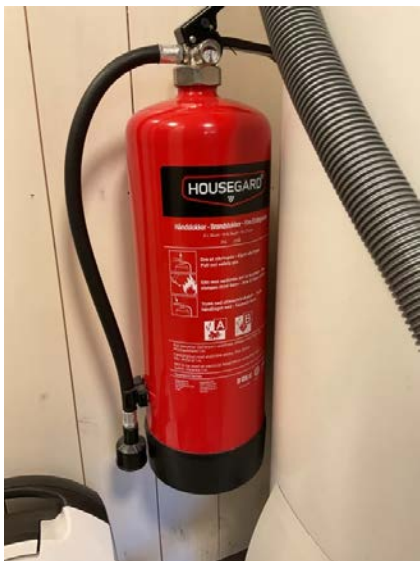
Brannslukker plassert på vaskerom.
