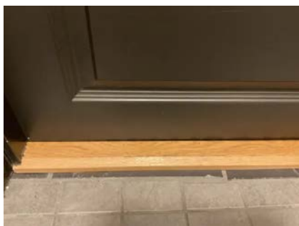
Manglende tilluft vaskerom.
