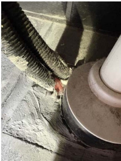
Manglende tetting av gjennomføring i gulv.
