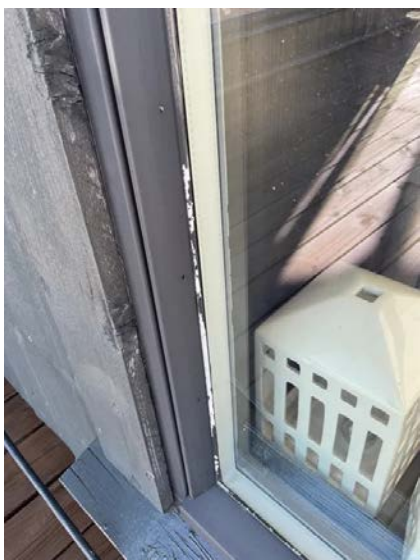
Avflassing av maling.
