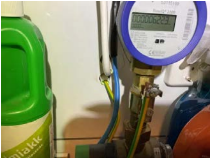
Utette gjennomføringer i vegg.
