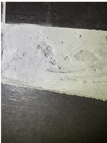
Manglende flis under innredning.
