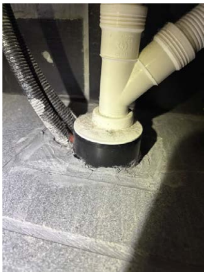
Manglende tetting av gjennomføring i gulv.
