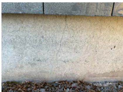
Sprekker i grunnmur.
