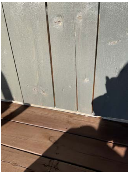
Sprekker i kledning.
