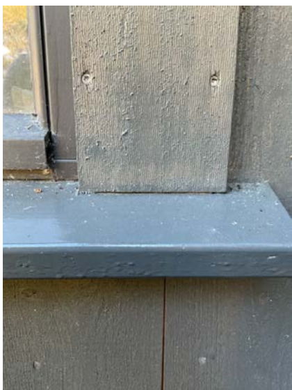
Kort avstand mellom panel og vannbrett.
