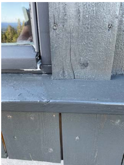
Kort avstand mellom panel og vannbrett.
