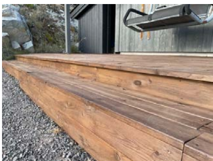
Skjevheter i gulvet.
