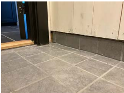
Ufulstendig membran ved dør og manglende sokkelflis.
