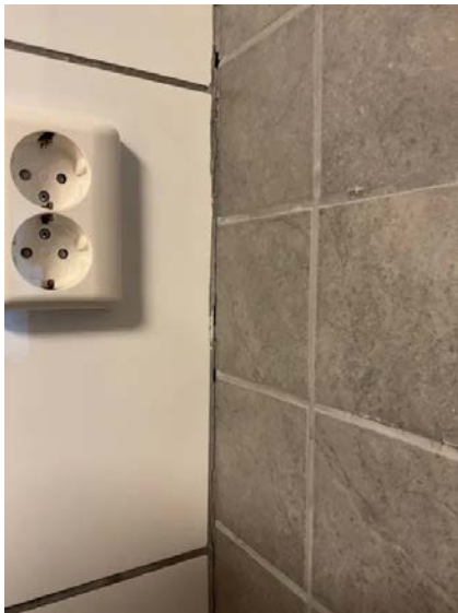
Sprekker i fugemasse/silikon.
