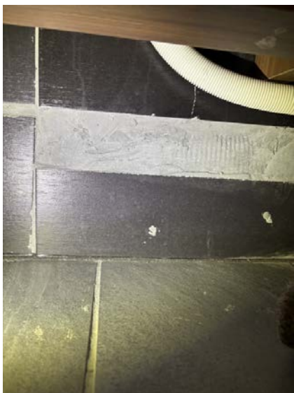
Manglende flis under innredning.
