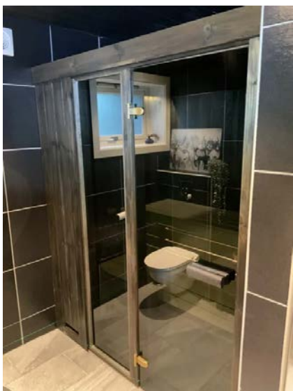
Ufulstendig membran ved dør og manglende sokkelflis.
