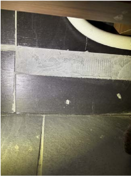
Manglende flis under innredning.
