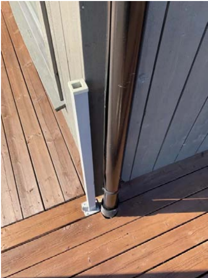
Frostspreg i nedløp.
