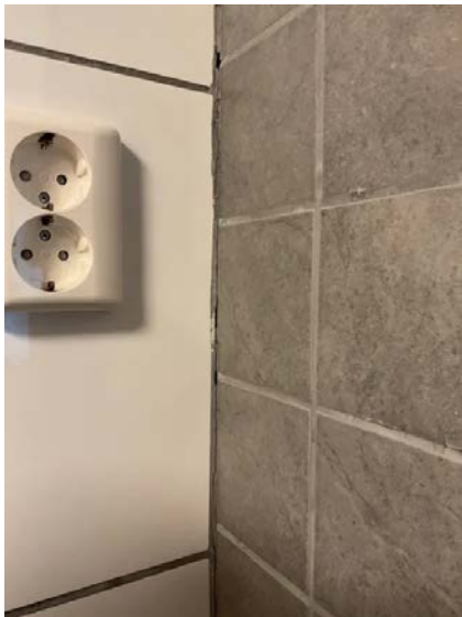
Sprekker i fugemasse/silikon.
