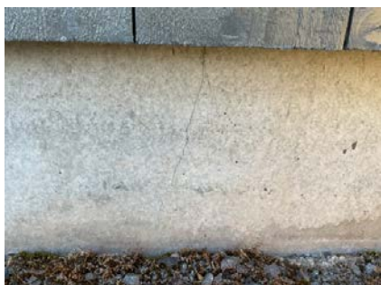
Sprekker i grunnmur.
