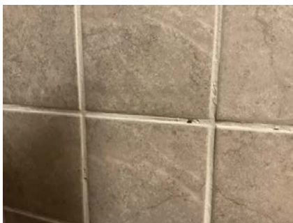
Sprekker i fugemasse/silikon.
