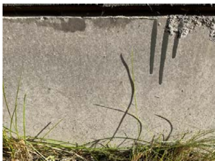
Sprekker i grunnmur.
