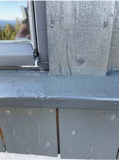
Kort avstand mellom panel og vannbrett.
