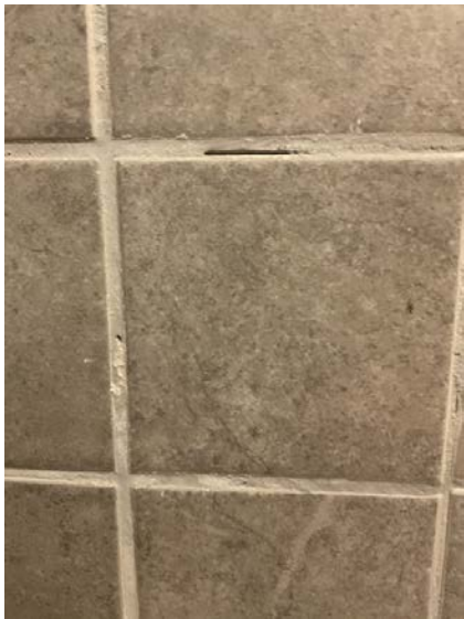
Sprekker i fugemasse/silikon.
