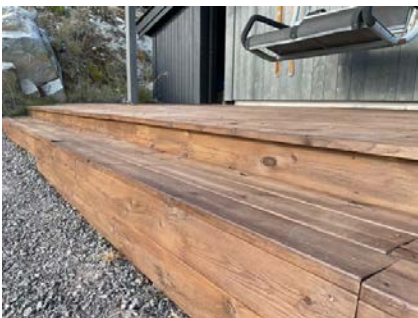
Skjevheter i gulvet.
