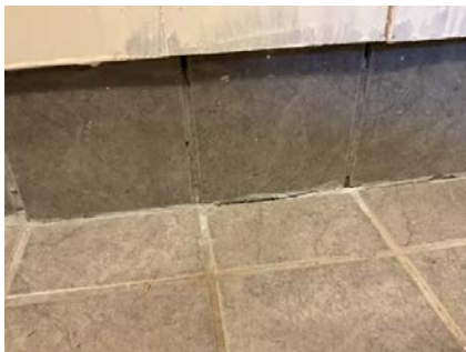
Sprekker i fugemasse/silikon.
