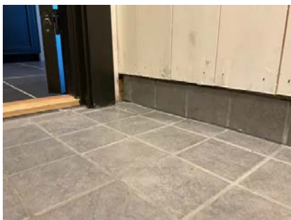
Ufulstendig membran ved dør og manglende sokkelflis.
