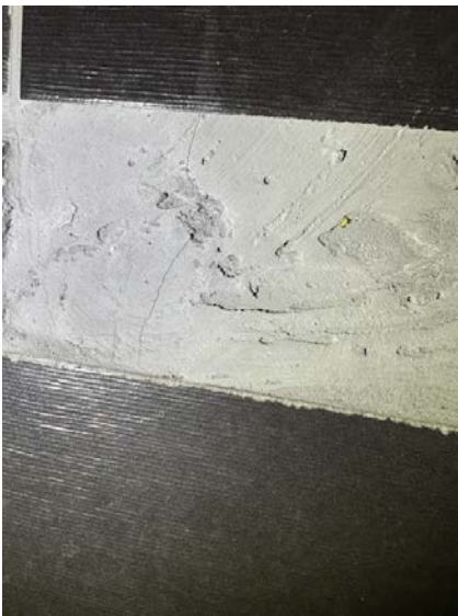
Manglende flis under innredning.
