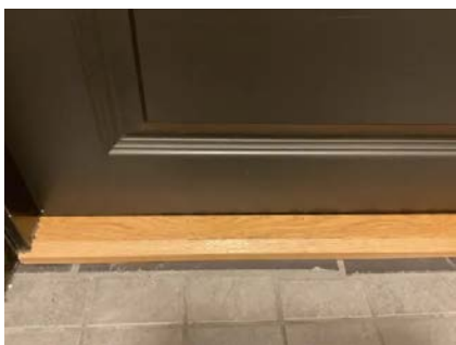
Manglende tilluft vaskerom.
