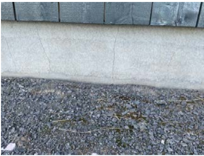
Sprekker i grunnmur.
