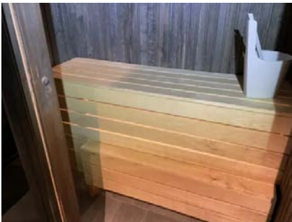
Ufulstendig membran ved dør og manglende sokkelflis.
