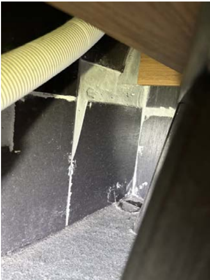
Manglende flis under innredning.
