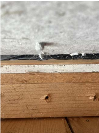
Manglende lufting av kledning.
