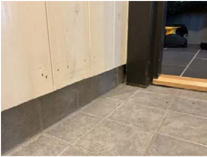
Ufulstendig membran ved dør og manglende sokkelflis.
