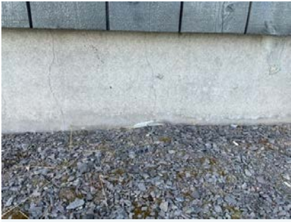
Sprekker i grunnmur.
