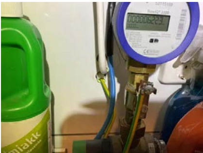
Utette gjennomføringer i vegg.
