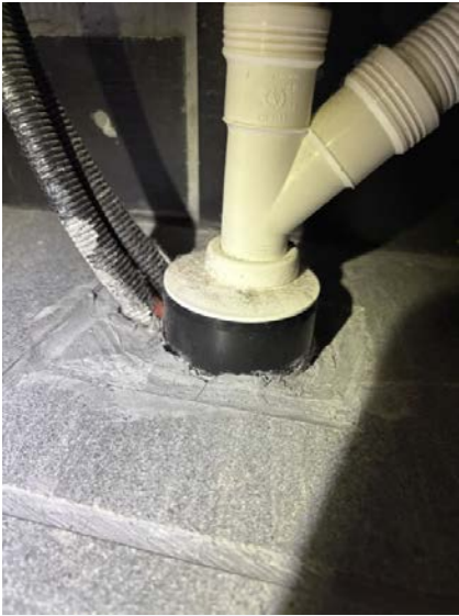
Manglende tetting av gjennomføring i gulv.
