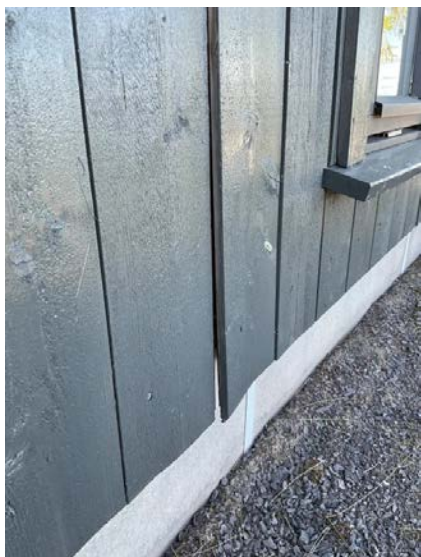
Sprekker i kledning.
