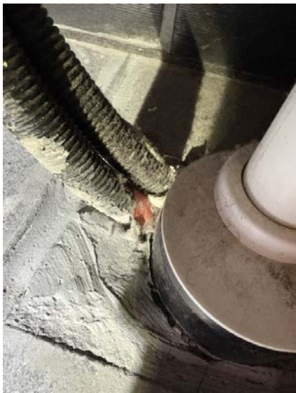
Manglende tetting av gjennomføring i gulv.
