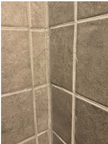
Sprekker i fugemasse/silikon.
