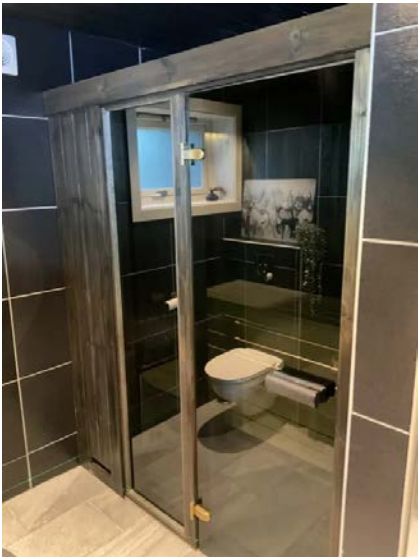
Ufulstendig membran ved dør og manglende sokkelflis.
