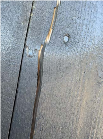
Sprekker i kledning.
