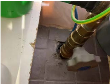
Utette gjennomføringer i gulv.
