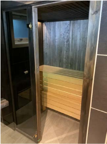
Ufulstendig membran ved dør og manglende sokkelflis.
