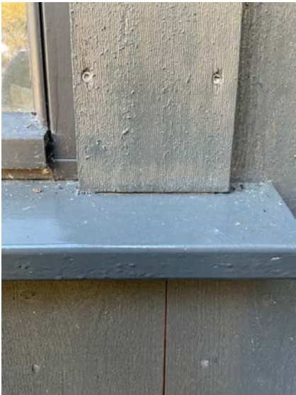
Kort avstand mellom panel og vannbrett.
