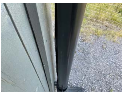
Frostspreg i nedløp.
