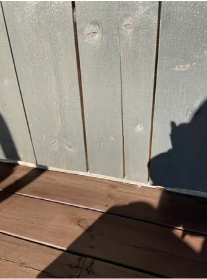
Sprekker i kledning.
