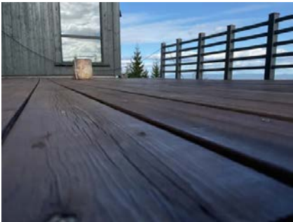
Skjevheter i gulvet.
