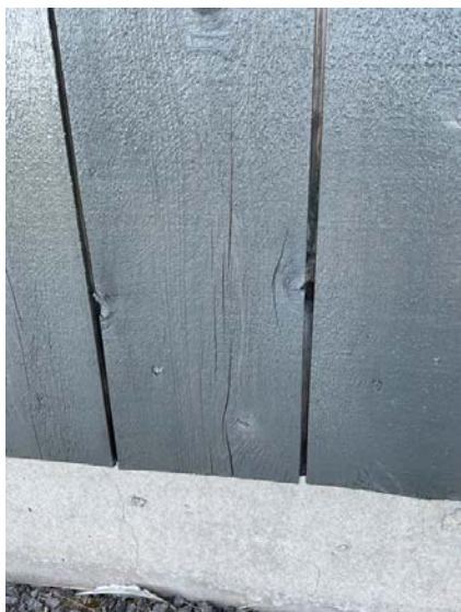
Sprekker i kledning.
