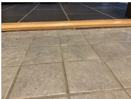
Manglende tettesjikt ved dør.
