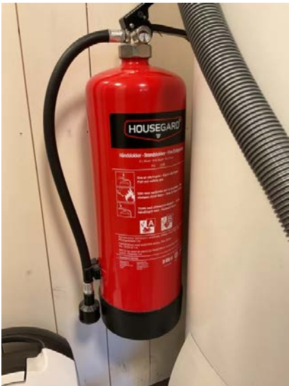
Brannslukker plassert på vaskerom.
