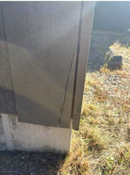
Sprekker i kledning.
