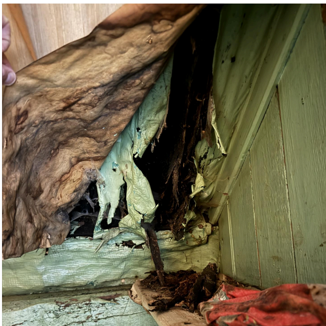
Skade synlig i kott
