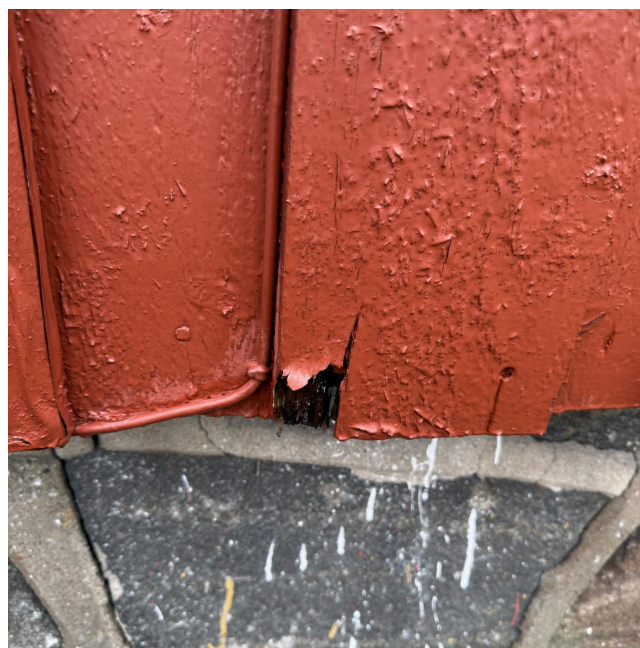
Råte i kledning
