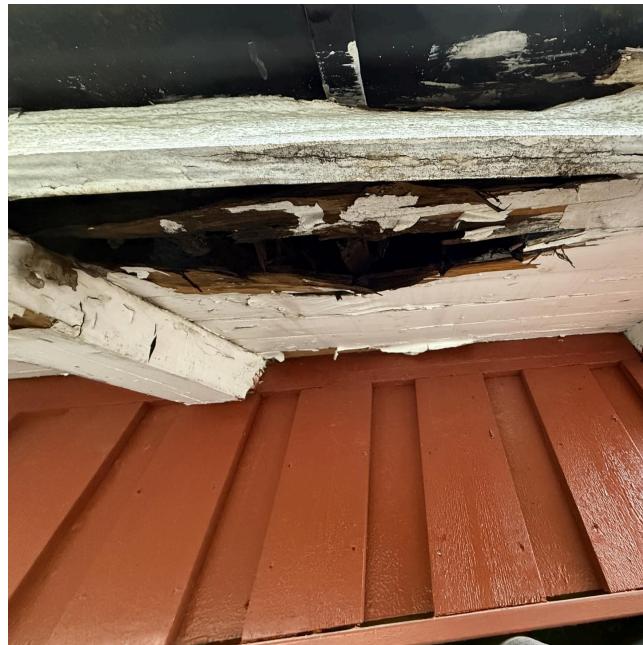
Råte i undertak/gesims
