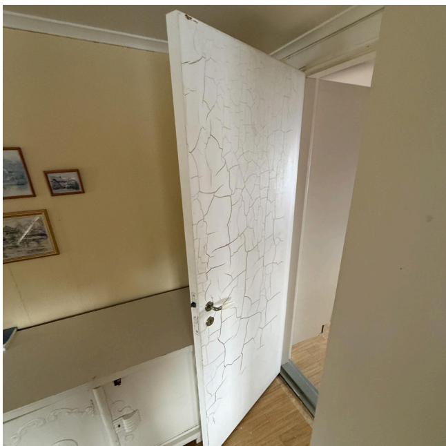
Sprekker i maling på dør
