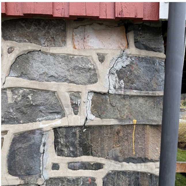
Sprekker i grunnmur.
