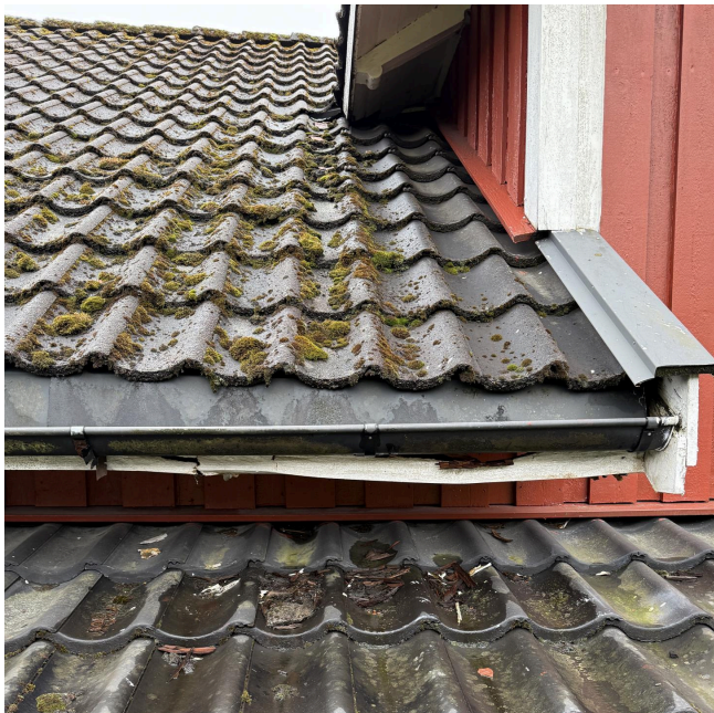
Taklekkasje, råte i pannebord
