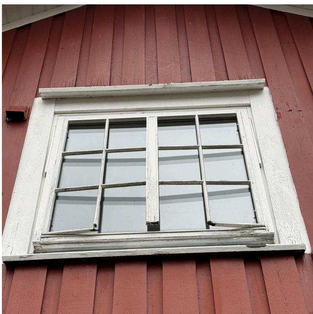
Defekt sprusse og råte i vindu.
