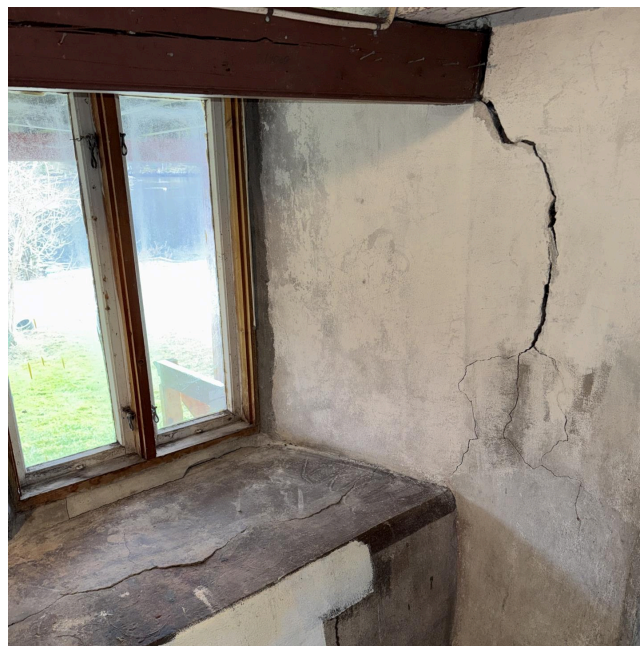
Sprekker i grunnmur.
