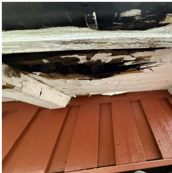
Råte i undertak/gesims
