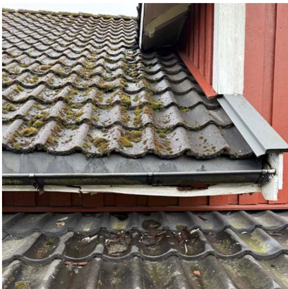
Taklekkasje, råte i pannebord
