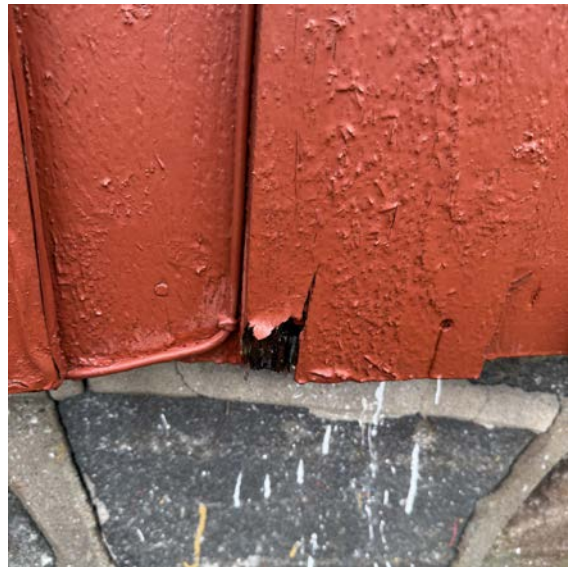
Råte i kledning
