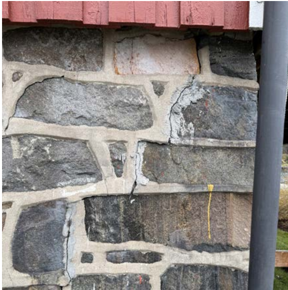
Sprekker i grunnmur.
