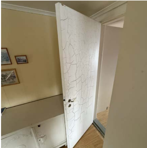
Sprekker i maling på dør
