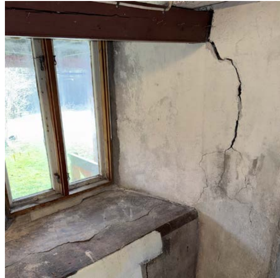
Sprekker i grunnmur.
