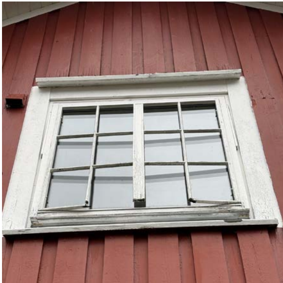
Defekt sprosse og råte i vindu.
