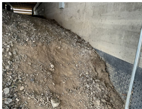
Avsluttet under terreng og manglende klemlist
