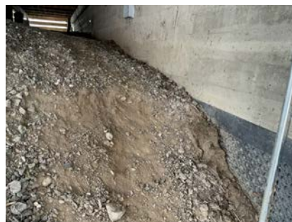
Avsluttet under terreng og manglende klemlist
