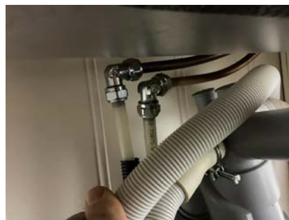
Synlig korrosjon på en kobling av vannrør til kjøkken i underetasje
