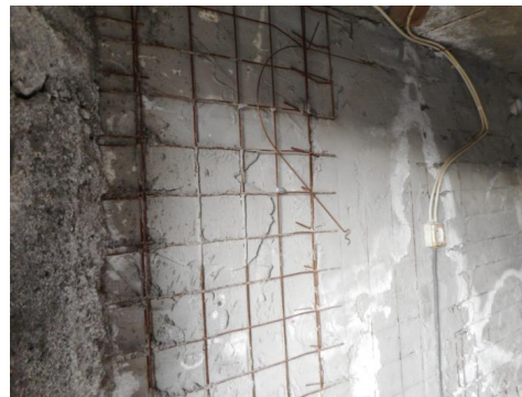
Synlig armering i garasje.
