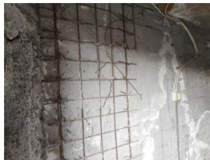
Synlig armering i garasje.
