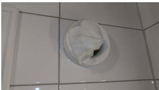
Test av avtrekket.
