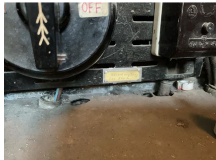
Manglende tetting av gjennomføringer.
