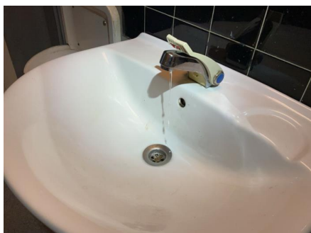
Armatur på bad står og renner.
