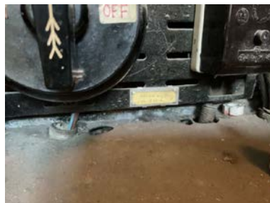
Manglende tetting av gjennomføringer.
