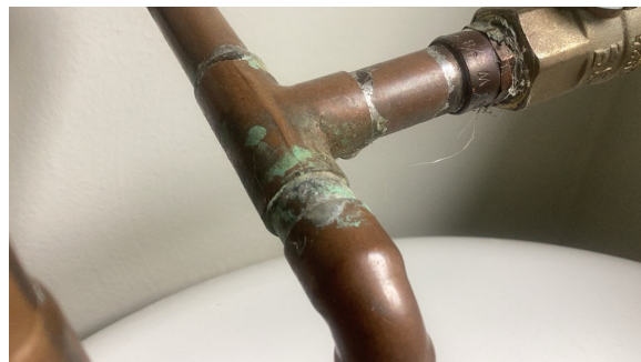
Irr på rør.
