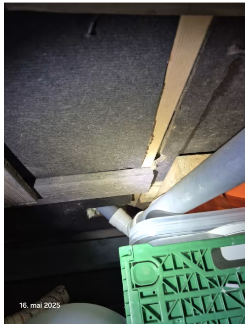
Sprekker/glipe mellom stubbloftsplate og bjelke.
