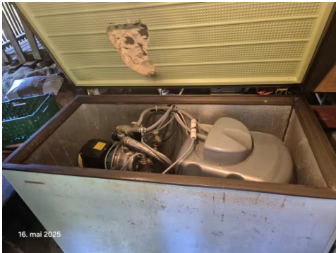
Bereder og vannpumpe.
