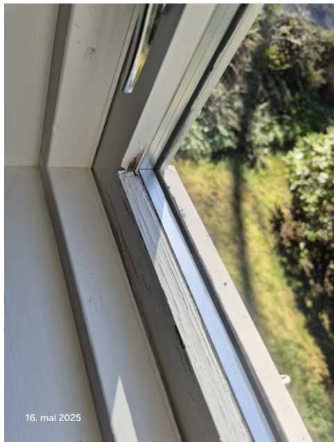
Avskallinger kan sees på bildet.
