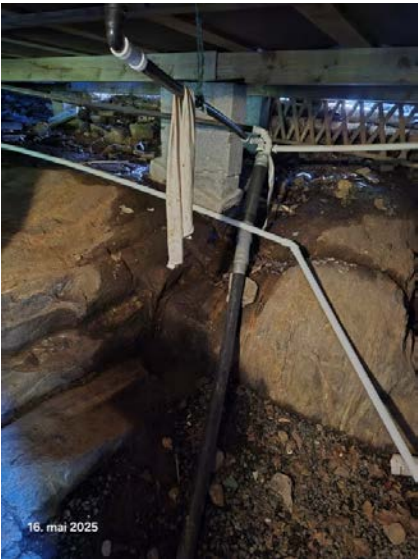
Bildet viser vanninnsig under hytta.
