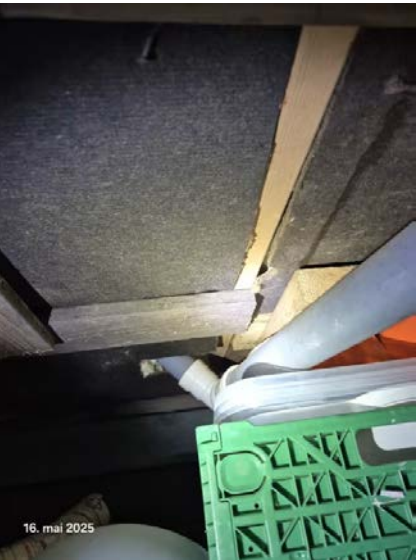
Sprekker/glipe mellom stubbloftsplate og bjelke.
