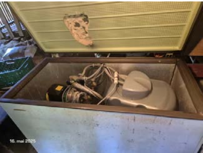
Bereder og vannpumpe.
