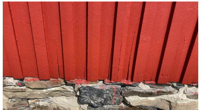
Sprekkdannelse i kledningsbord
