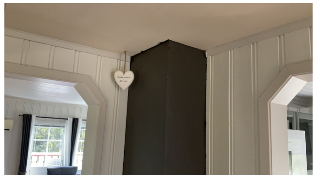
Brennbart material inntil skorstein
