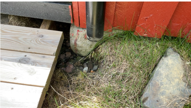
Mangler bortledning av takvann fra et nedløp, takvann bør føres vekk fra bygningskropp for å unngå oppfukning
