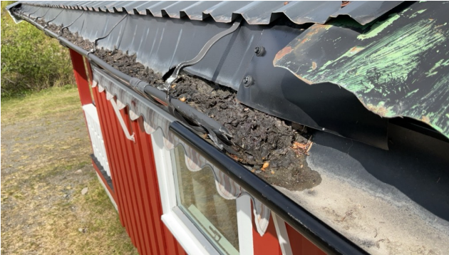
Skjøl mellom tekkinger har utettheter, manglende forkantbeslag på tekking fra byggeår
