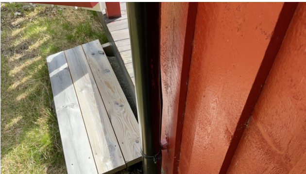
Frostspreng på nedløp
