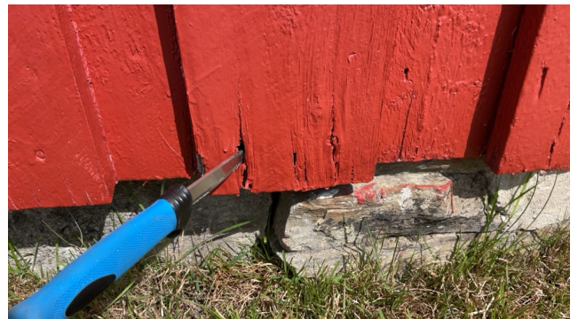
Råteskader spredt på bordkledning er registrert i endevend, må foretas nærmere undersøkelse og tiltak av årsak/omfang. Kontroll av veggkonstruksjon bør foretas
