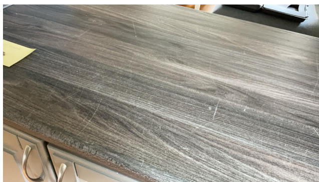
Slitasje på benkeplate
