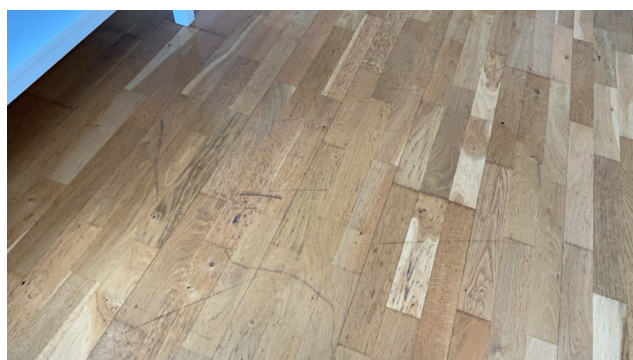
Slitasje og riper på gulvoverflate
