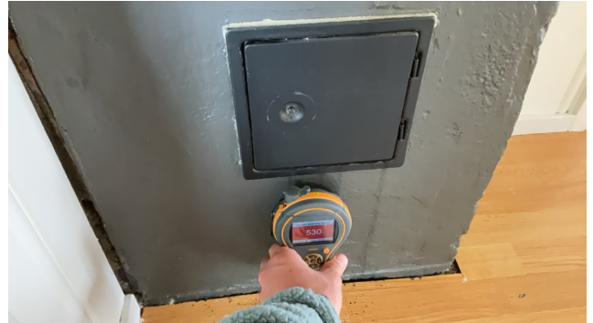
Rennermerke fra sotluke, ved fuktmåletaking med overflatesøk av fuktmåler var det fuktutslag Manglende ubrennbar plate på gulv under sotluke
