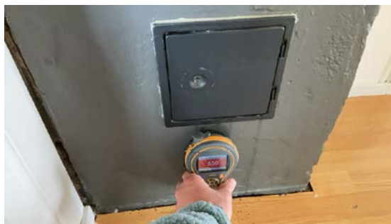
Rennmerke fra sotluke, ved fuktmåletaking med overflatesøk av fuktmåler var det fuktutslag Manglende ubrennbar plate på gulv under sotluke
