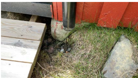
Mangler bortledning av takvann fra et nedløp, takvann bør føres vekk fra bygningskropp for å unngå oppfukting
