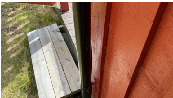
Frostspreng på nedløp
