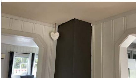
Brennbart material inntil skorstein
