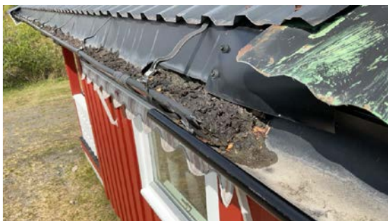
Skjøt mellom tekkinger har utettheter, manglende forkantbeslag på tekking fra byggeår
