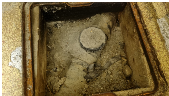
Avløpsrør under støpt plate er fra byggeår.
