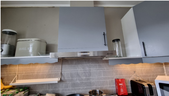
Det er kjøkkenventilator med avtrekk ut.
