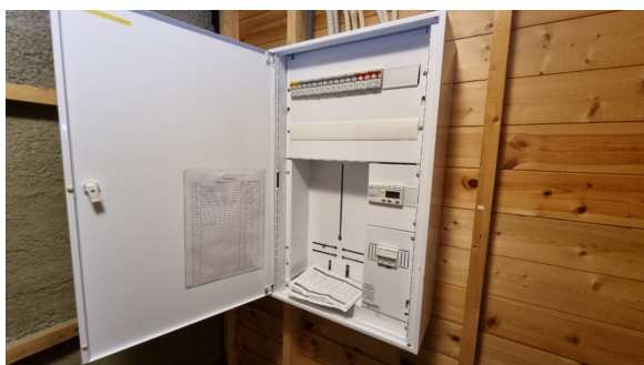
El-skap i sokkeletasjen
