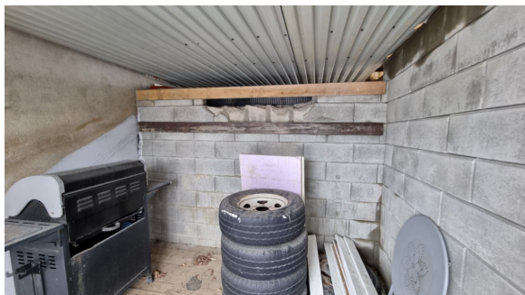
Det er steiner med skader
