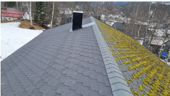
Det mangler stigetrinn til pipe.
