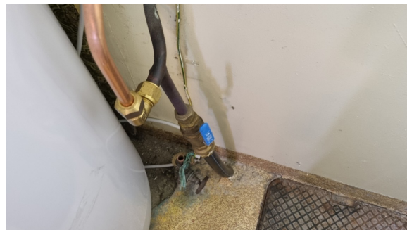
Innvendig hovedstoppekran med kuleventil.
