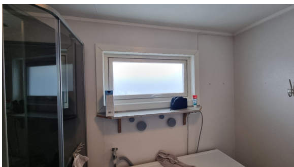
Det er vindu i våtsonen ved dusjkabinett.
