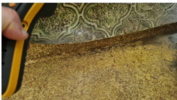
Våtromstapet har stedvis løsnet.
