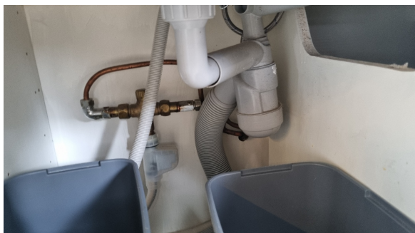
Vannledninger av kobber
