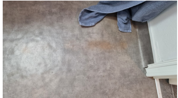
Missfarging i belegg.
