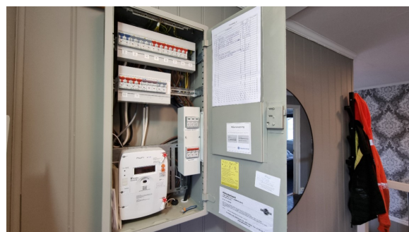
El-skap i hovedetasjen
