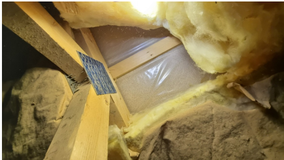
Kontroll av underliggende dampsperre og spor etter mus.
