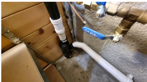
Det er avløpsrør av plast.
