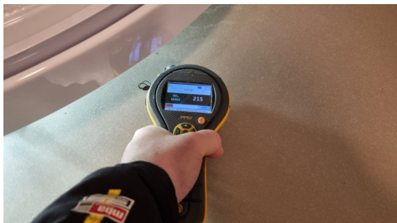
Det ble registrert forhøyde fuktverdier.
