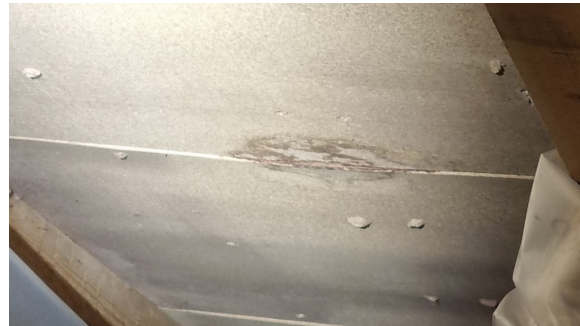
Fuktmerke etter tidligere lekkasje.
