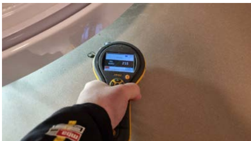
Det ble registrert forhøyet fuktverdier.
