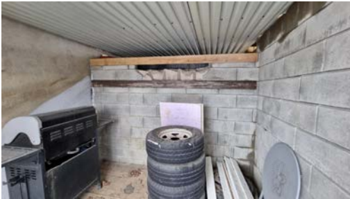
Det er steiner med skader
