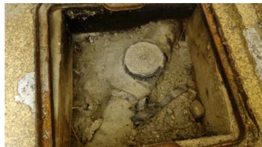
Avløpsrør under støpt plate er fra byggeår.
