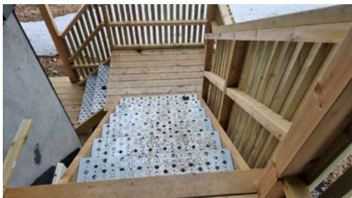
Trapp har ikke rekkverk på begge sider.
