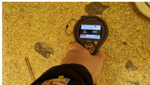
Det ble fuktmålt ved befarings, forhøyde fuktverdier ble registrert.
