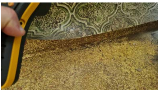
Våtromstapet har stedvis løsnet.
