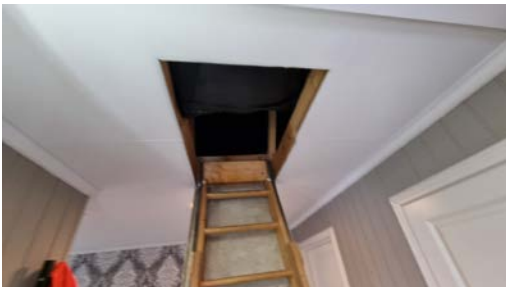
Det bemerkes at loftsluken til kaldloft er uisolert og uten tetningslist.
