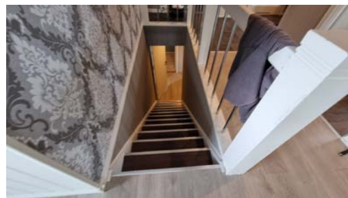
Det mangler håndløper på vegg i trappeløpet.
