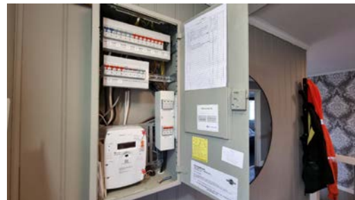
El-skap i hovedetasjen
