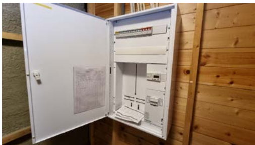
El-skap i sokkeletasjen
