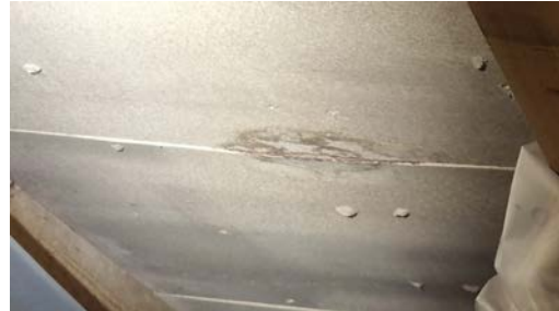
Fuktmerke etter tidligere lekkasje.
