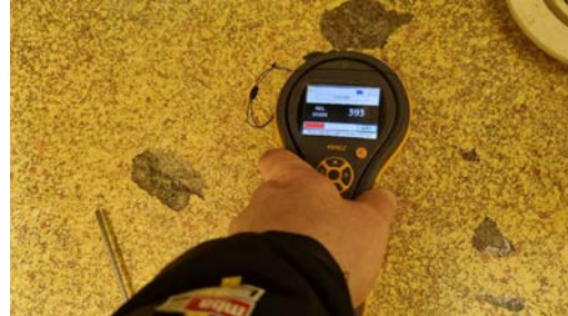
Det ble fuktmålt ved befarings, forhøyde fuktverdier ble registrert.
