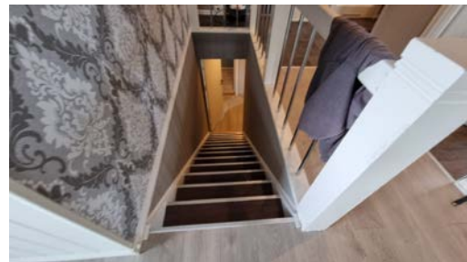
Det mangler håndløper på vegg i trappeløpet.
