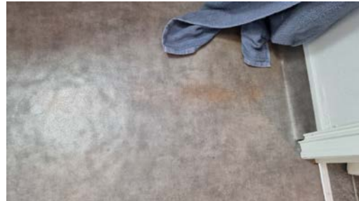
Missfarging i belegg.
