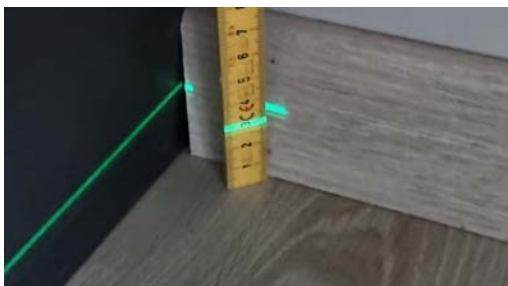
Kontroll av planavvik.
