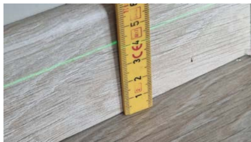
Kontroll av planavvik.
