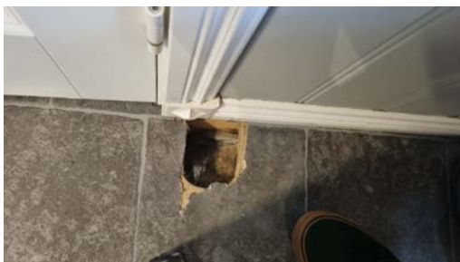
Det er hull i gulvet
