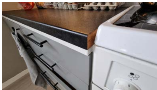
Det mangler laminering på endene av benkeplaten ved komfyrområdet.
