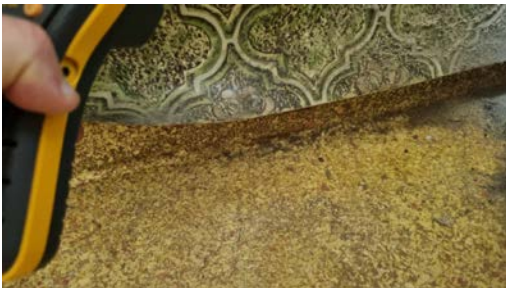
Våtromstapet har stedvis løsnet.
