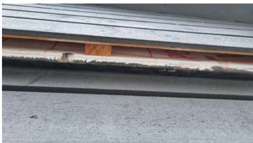
Det anbefales å etablere tilfredsstillende tildekking av vindsperren for å beskytte denne mot ytre påvirkninger.
