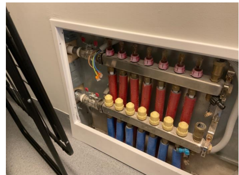
Vannbåren varme i leilighet
