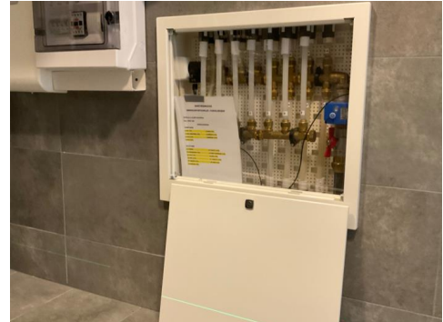
Rør-i-rør skap, bolig
