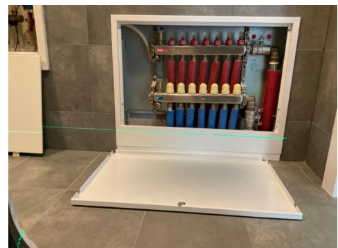
Vannbåren varme i bolig
