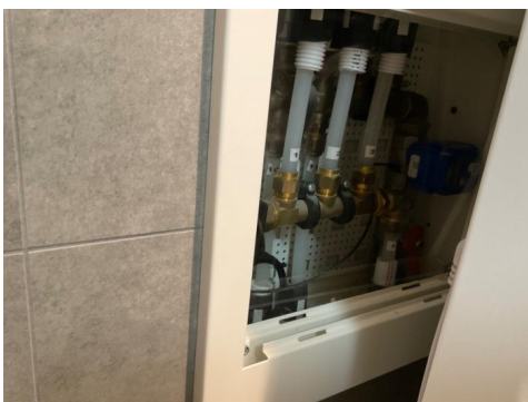
Rør-i-rør skap, leilighet
